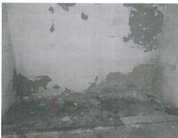
Zawilgocenie ściany przy posadce
