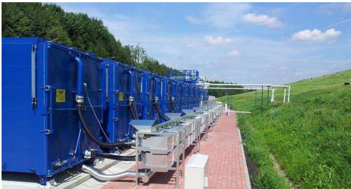
Rysunek 5 Kompostownia kontenerowa (widoczna instalacja napowietrzająca)
