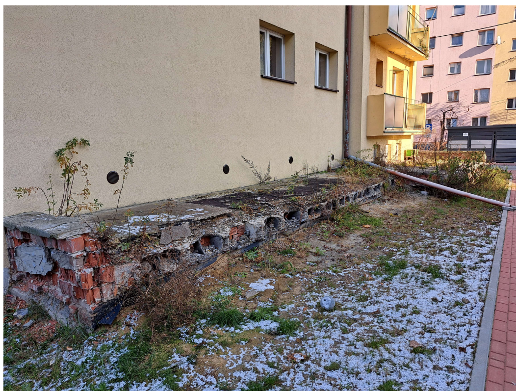
Fot 04 – Piwnica ozn. nr 1. Ospojony tynk i cegły ze ścian nośnych.
