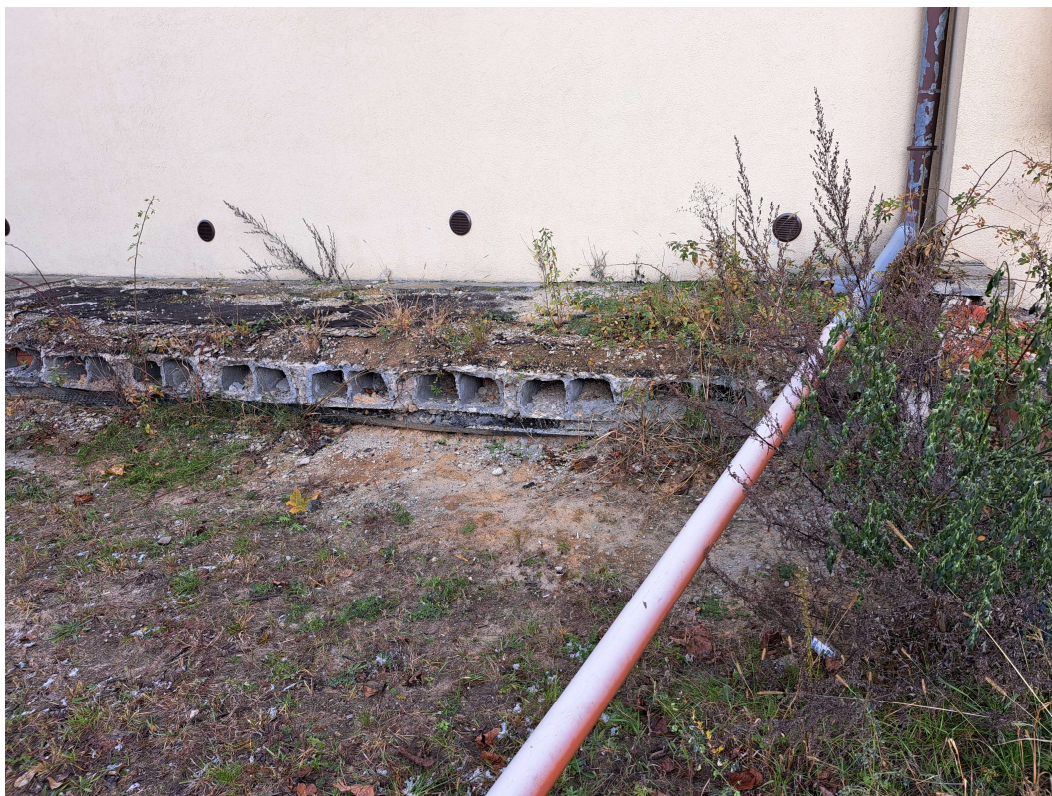
Fot. 03 – Piwnica ozn. nr 1. Widoczna roślinność pokrywająca płytę stropu.
