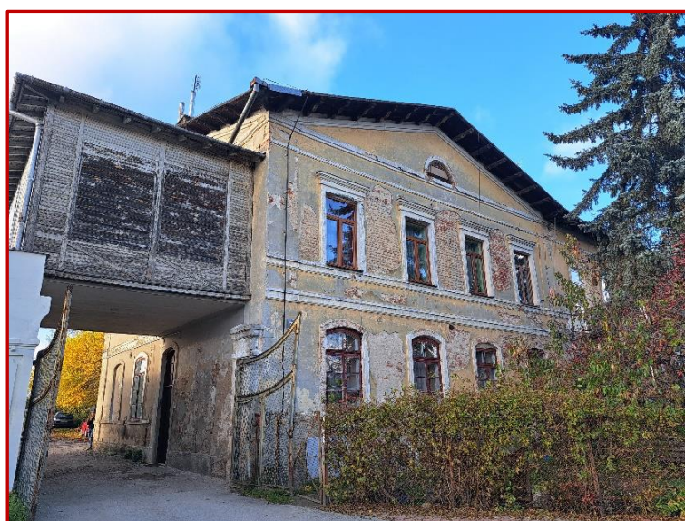
Rysunek 18. Zlokalizowany na obszarze rewitalizacji budynek komunalny w złym stanie technicznym
