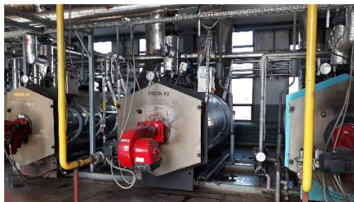
Zdjęcie 4 Kotłownia wodna
