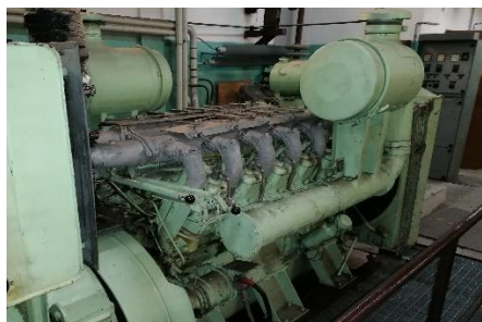
Zdjęcie 3 Agregat prądotwórczy
