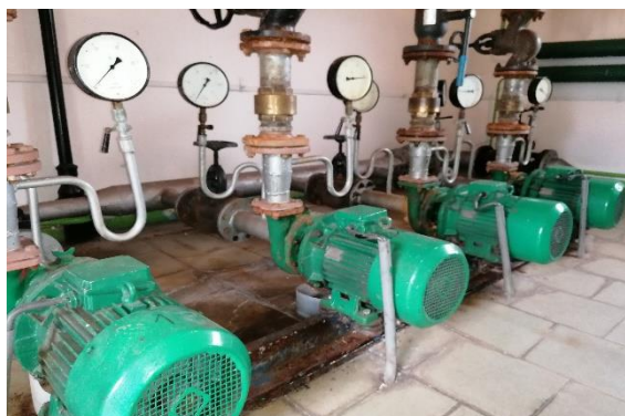
Zdjęcie 5 Stacja pomp hydroforowych
