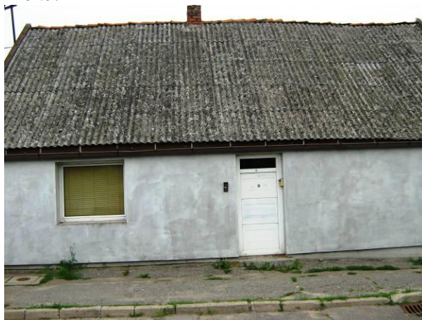
Rys. 7. Pokrycie dachowe ocenione w II stopniu pilności.
