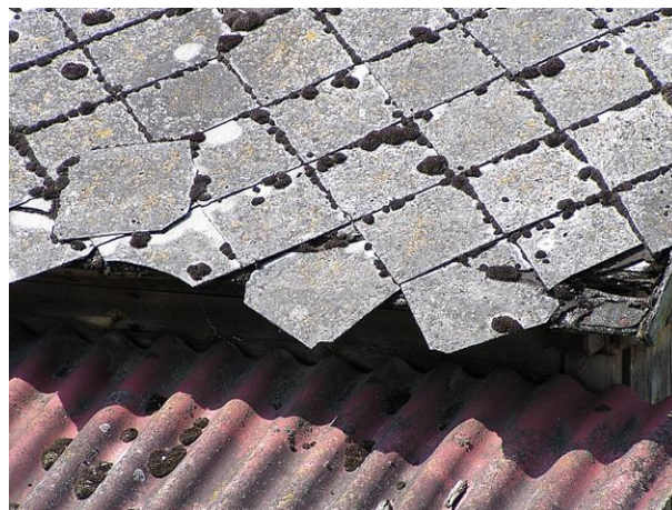
Rys. 8. Pokrycie dachowe ocenione w I stopniu pilności.
