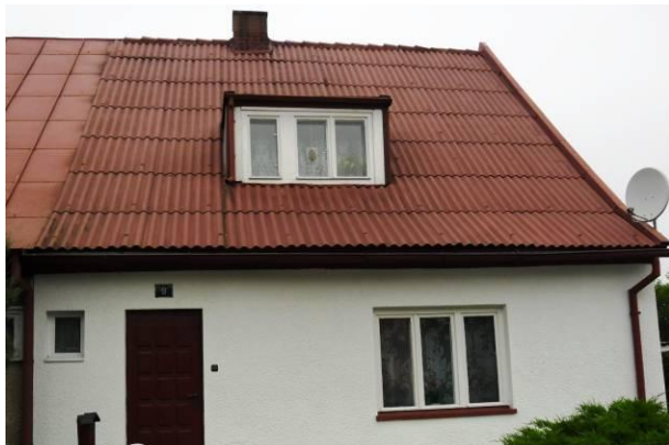
Rys. 6. Pokrycie dachowe ocenione w III stopniu pilności.
