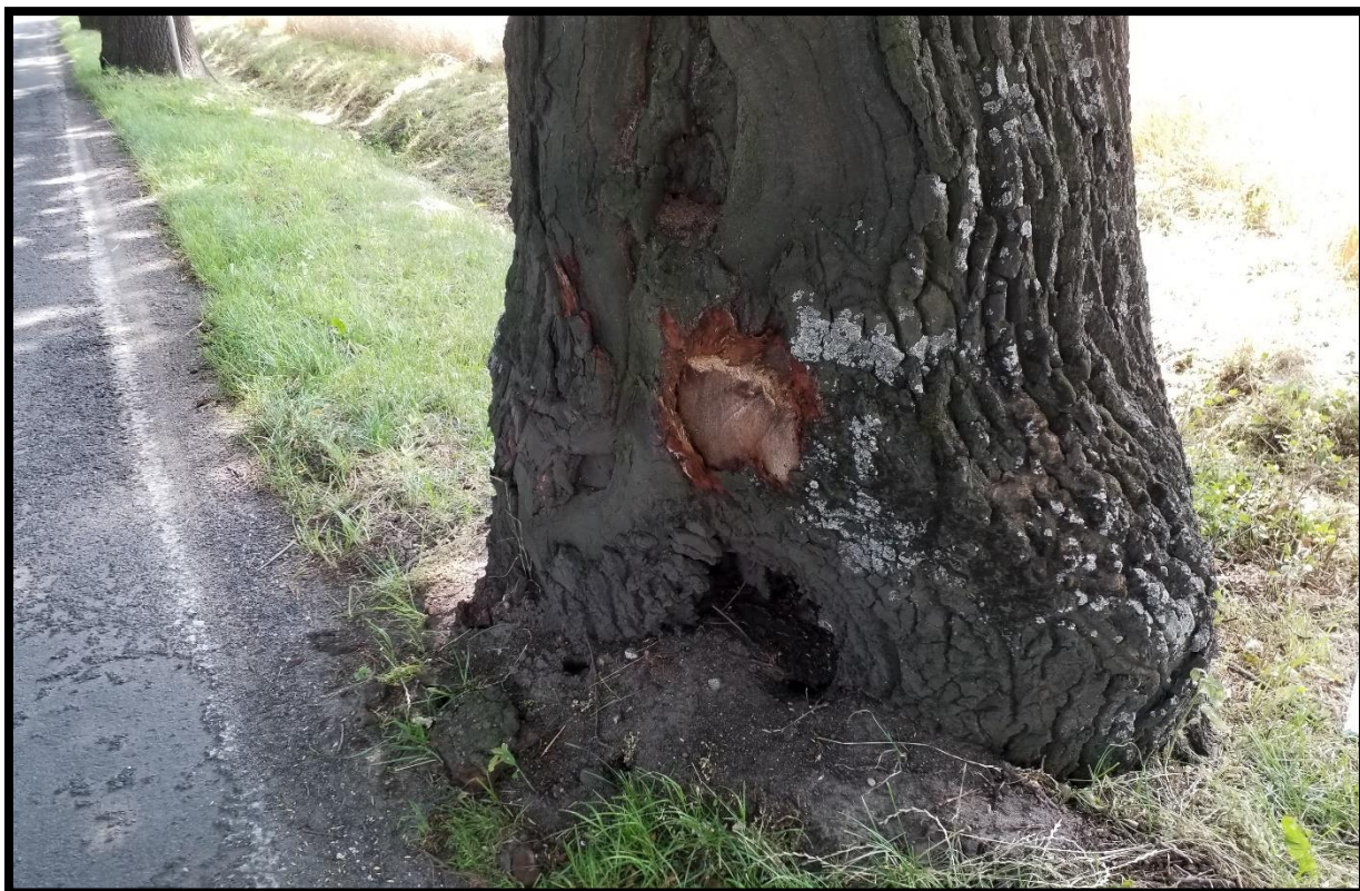
Fot. 110. Uszkodzenia pnia u podstawy
