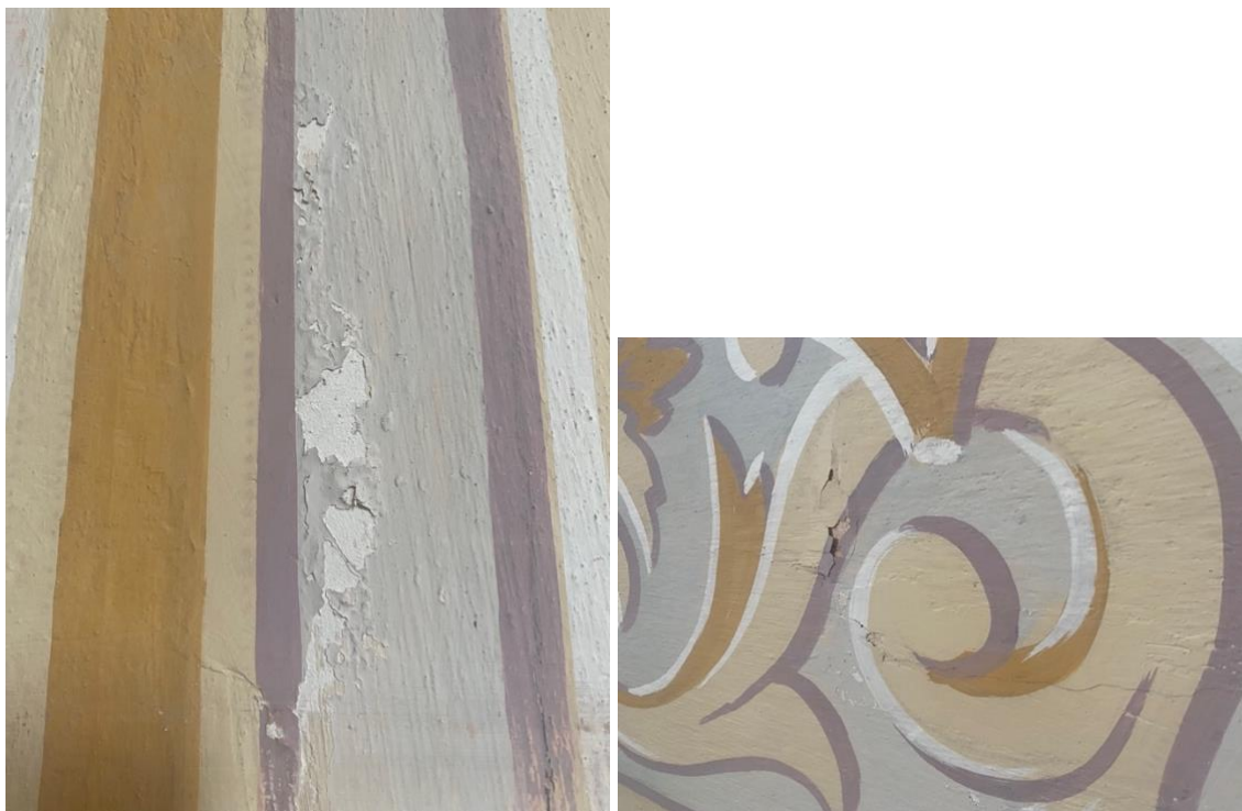
Fot. 41,42 Kościół pw. św. Floriana w Krysku. Przykłady degradacji polichromii.
