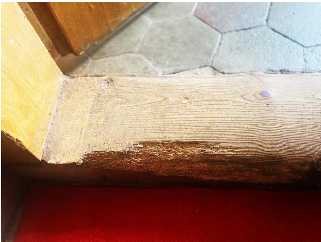
Fot. 9 Kościół pw. św. Floriana w Krysku. Ściana tylna ołtarza głównego, widoczne porażenia przez owady z rodziny kołatkowatych dolnego progu drzwi wejściowych do zakrystii głównej
