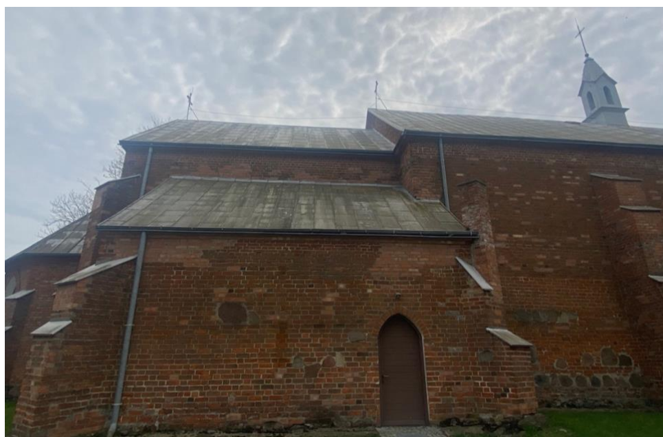
Fot. 37 Kościół pw. św. Floriana w Krysku. Przykłady degradacji połaci dachowej.
