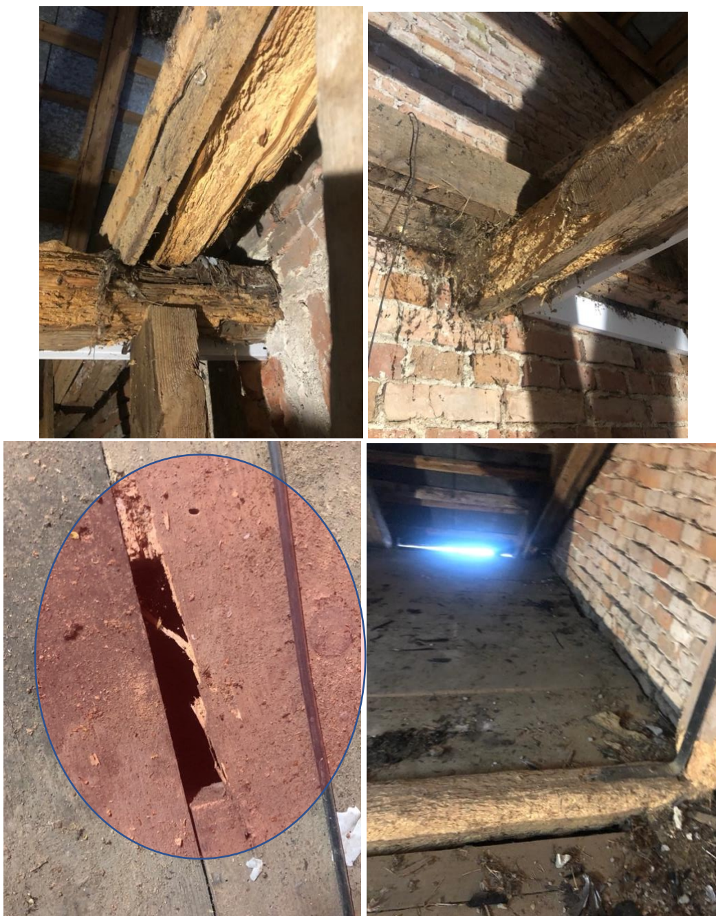
Fot. 31 - 34 Kościół pw. św. Floriana w Krysku. Widok szczegółowy porażonej więźby dachowej – degradacja połączeń ciesielskich. Fot 33 ślady porażenia deskowania podłogi. Fot 34 widoczne nieszczelności poszycia dachowego.
