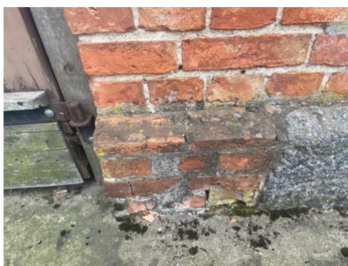
Fot. 35,36 Kościół pw. św. Floriana w Krysku. Przykłady degradacji muru.
