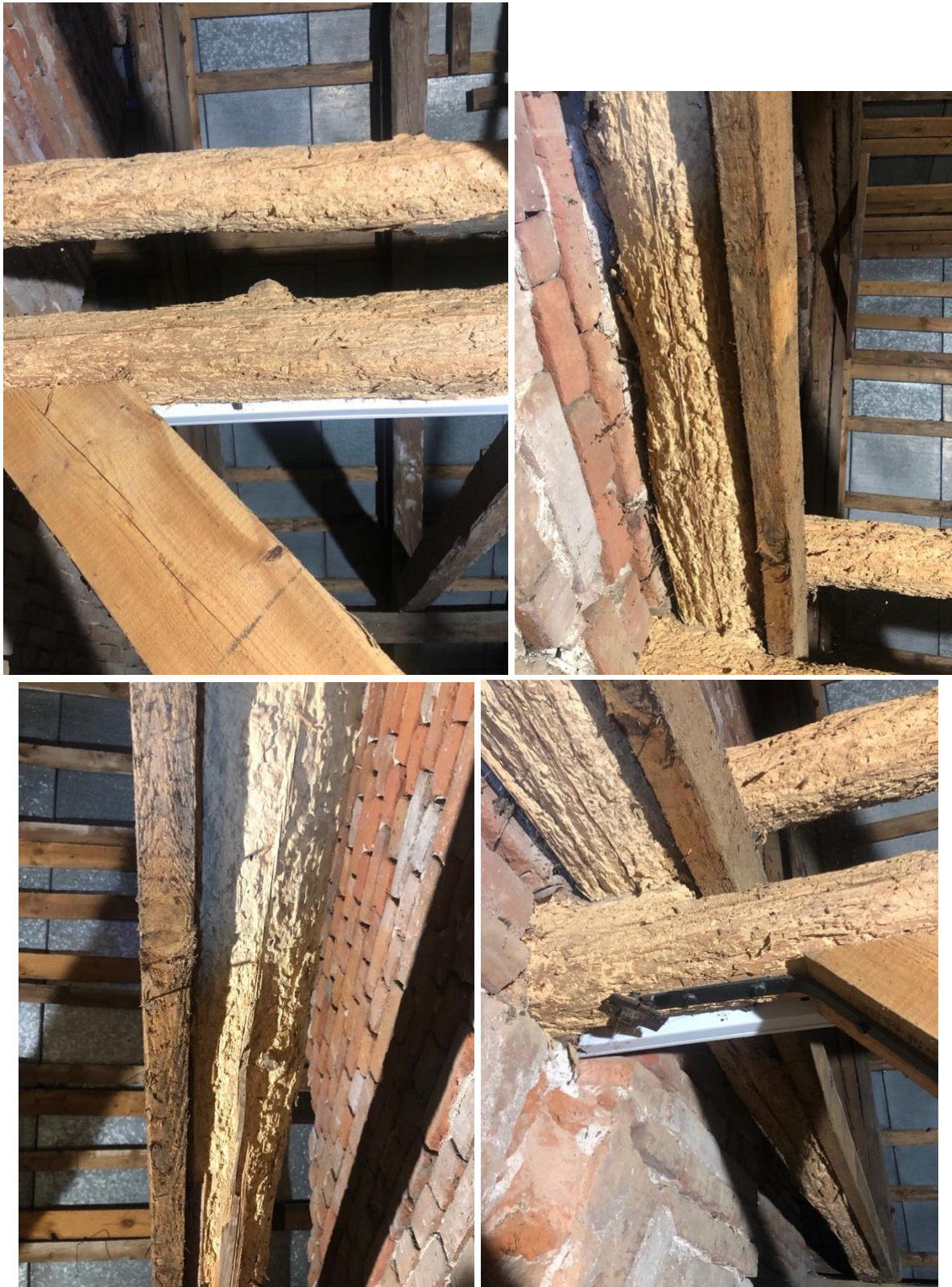
Fot. 15-18 Kościół pw. św. Floriana w Krysku. Widok szczegółowy porażonej więźby dachowej. Widoczne znaczne porażenia przez owady z rodziny kózkowatych i ślady rekonstrukcji.
