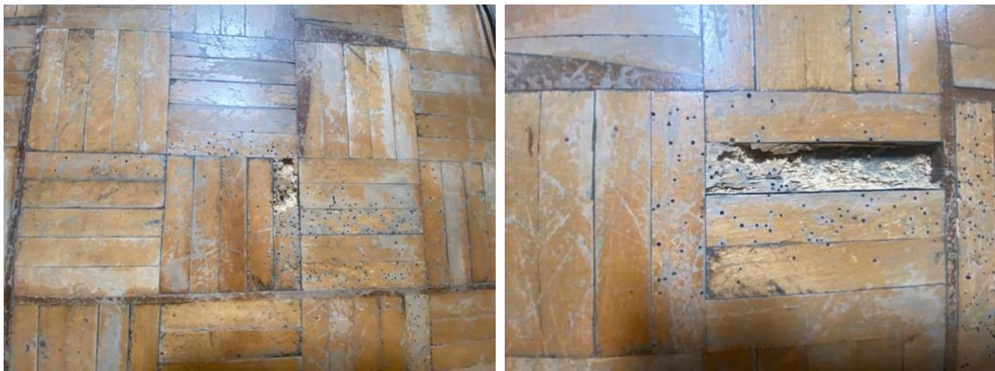
Fot. 7-8 Kościół pw. św. Floriana w Krysku. Ściana tylna ołtarza głównego, widoczne przykłady obszarowego porażenia przez owady z rodziny kołatkowatych, posadzki w strefie prezbiterium.
