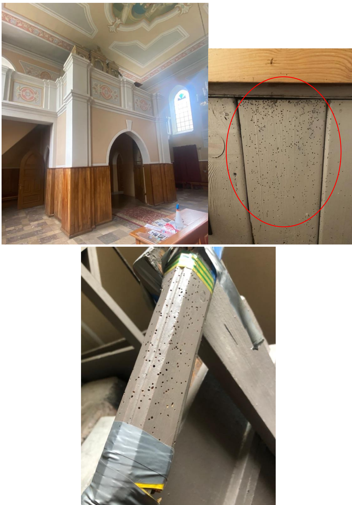
Fot. 4 Fot. a, b i c Kościół pw. św. Floriana w Krysku. Widok ogólny choru i detal porażenia. Ściana tylna widoczne porażenia deskowania przez owady z rodziny kołatkowatych.
