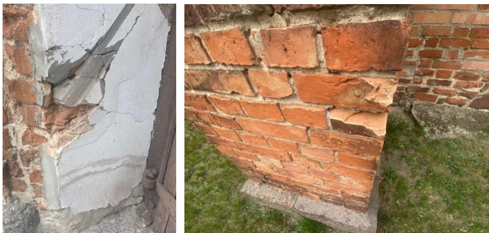
Fot. 35,36 Kościół pw. św. Floriana w Krysku. Przykłady degradacji muru.
