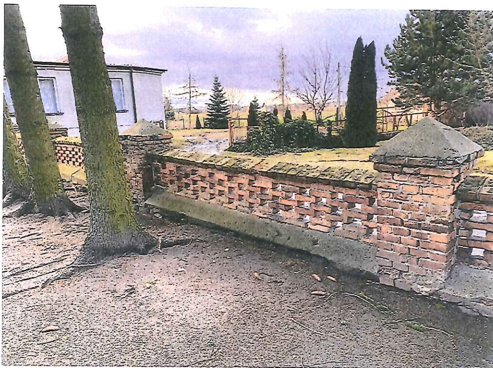
ZD4 – Odchylenie ściany od strony północnej – brak ściany oporowej
