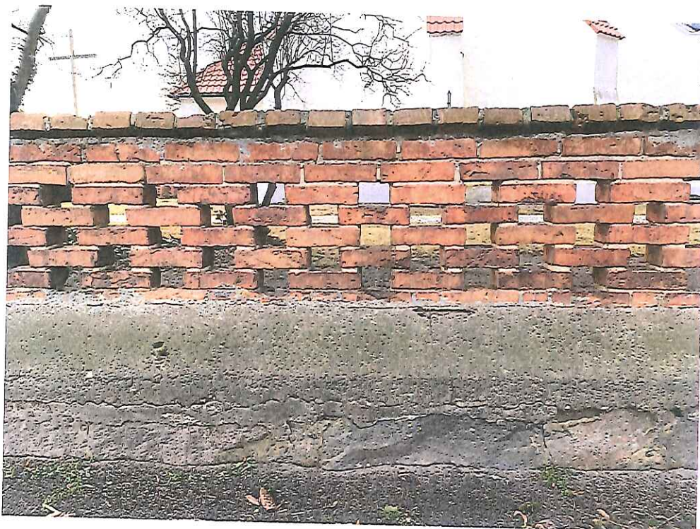
ZD1 – Pęknięcie pionowe fundamentu
