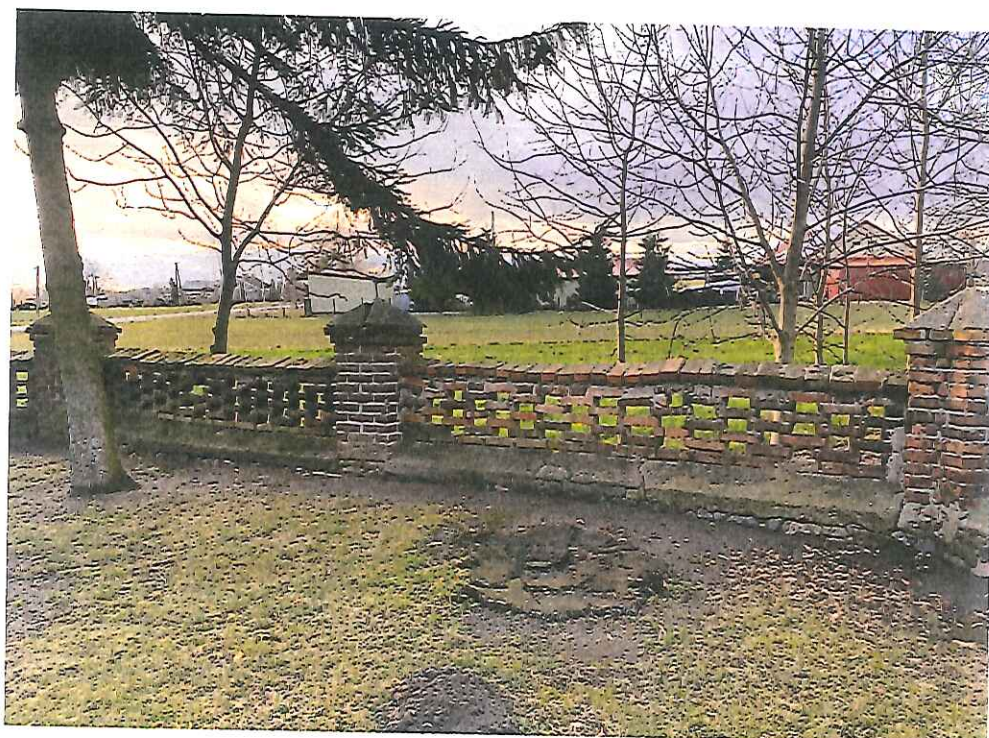
ZD2 – Zniszczenia muru od strony zachodniej
