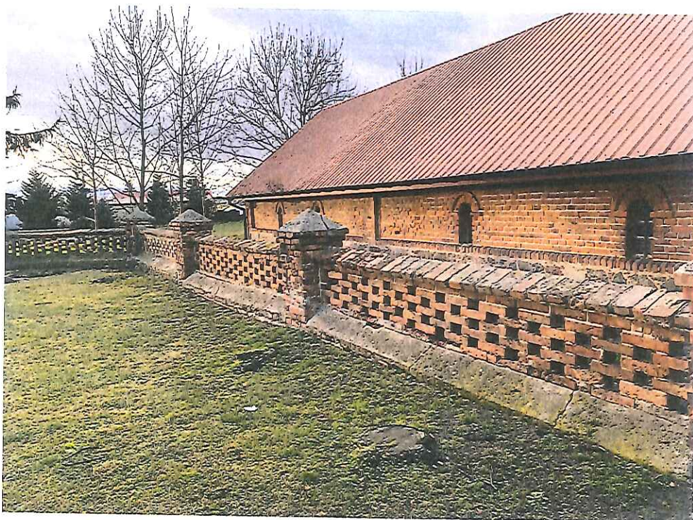
ZD3 – Pionowa rysa oraz ubytek zewnętrznej warstwy ogrodzenia
