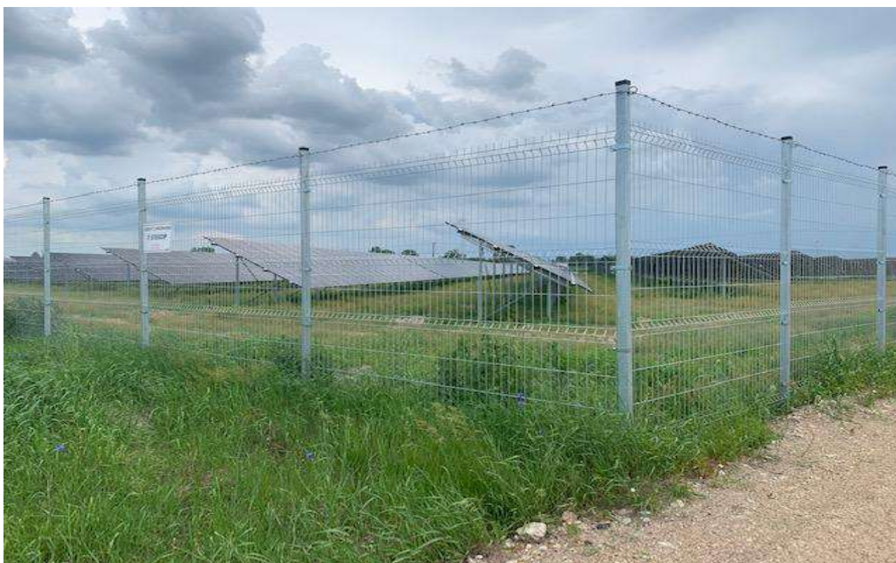
Fot. 9. Farma fotowoltaiczna za ażurowym ogrodzeniem.
