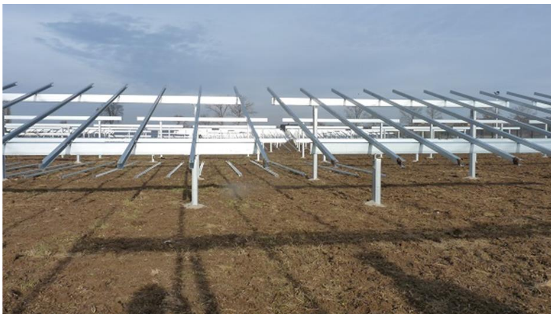
Fot. 2 Konstrukcja stalowa stelaży pod moduły fotowoltaiczne
