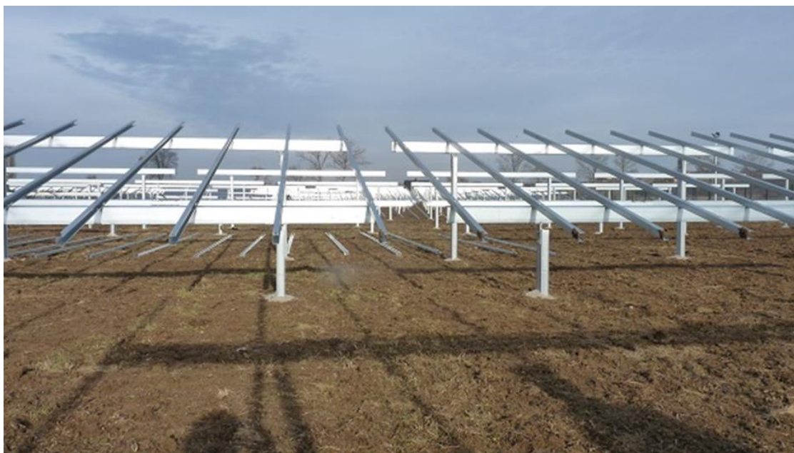
Fot. 2 Konstrukcja stalowa stelaży pod moduły fotowoltaiczne
