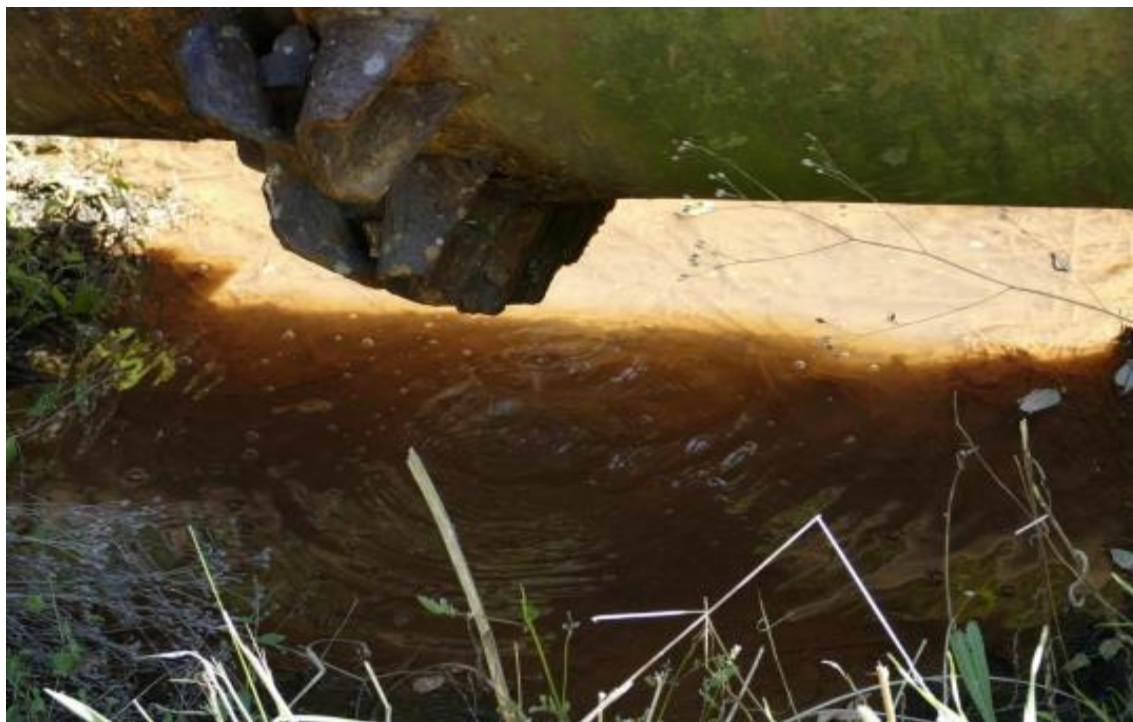
Rysunek 224 Nieszczelny rurociąg
