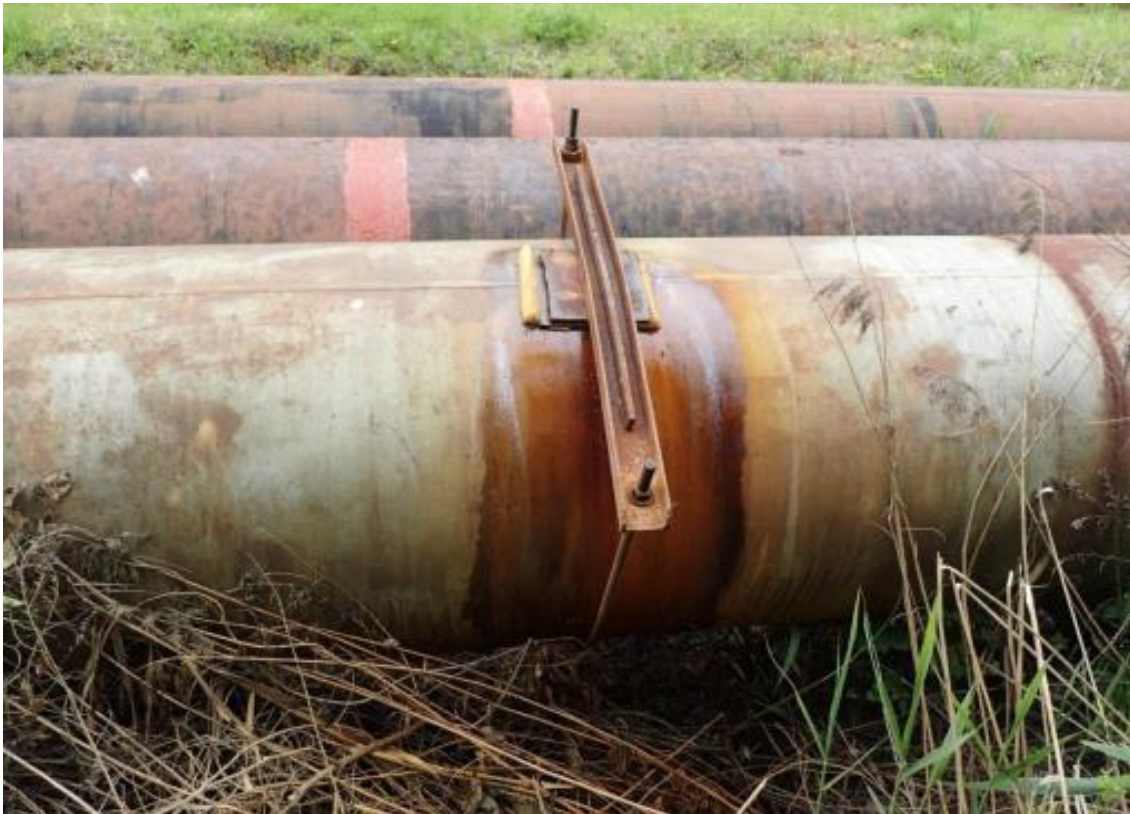
Rysunek 227 Nieszczelny rurociąg
