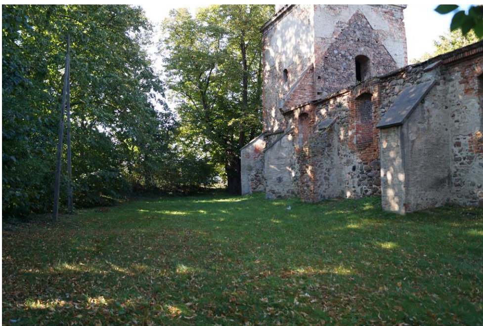
Górzyn, ruina kościoła, stan wrzesień 2025 r.
