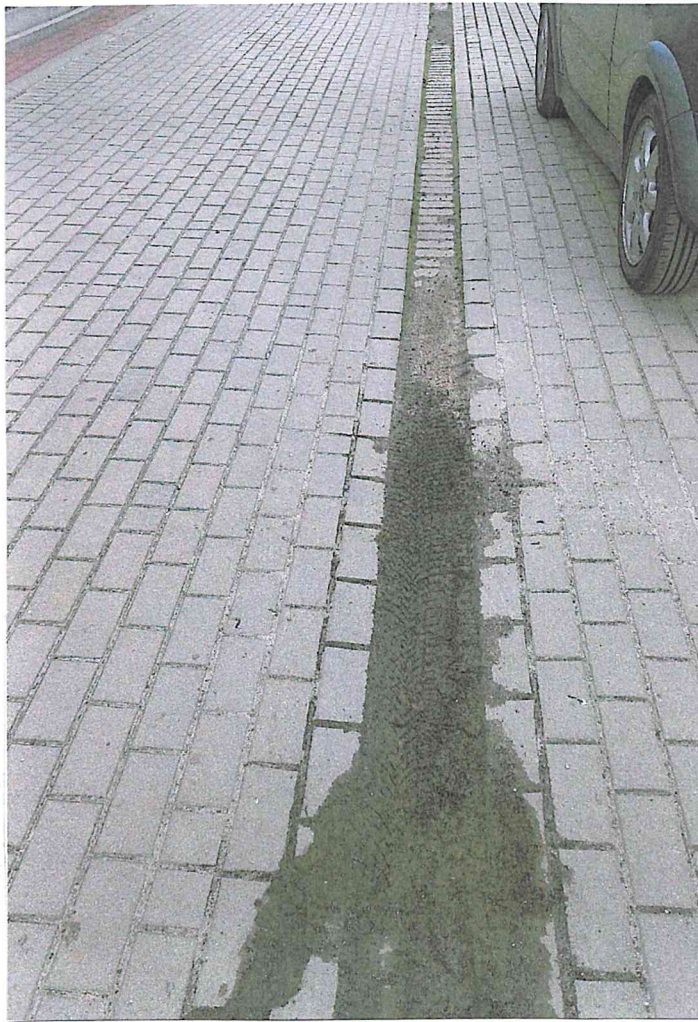
Źle wyprofilowana nawierzchnia
