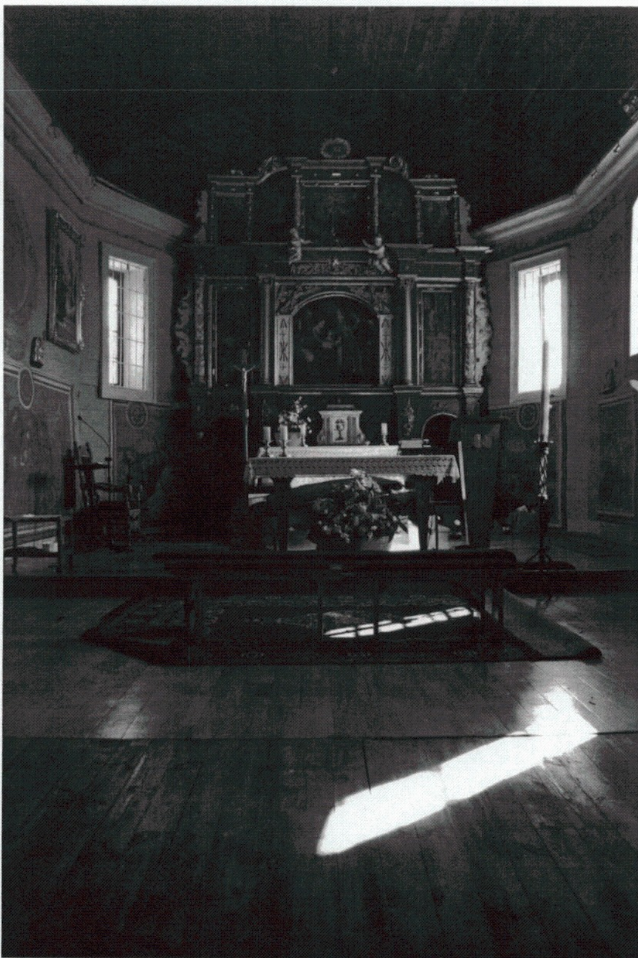
Fot 1 Kościół pw. Św. Wawrzyńca w Macznikach. Widok na prezbiterium, z zaznaczonym nierównomiernym połączeniem dwóch rodzajów desek podłogowych. Widoczne zniszczenia drewna. Fotografia wykonana przed pracami konserwatorskimi z lat 2017-19. Fot. Ewa Tymcik, 2017
