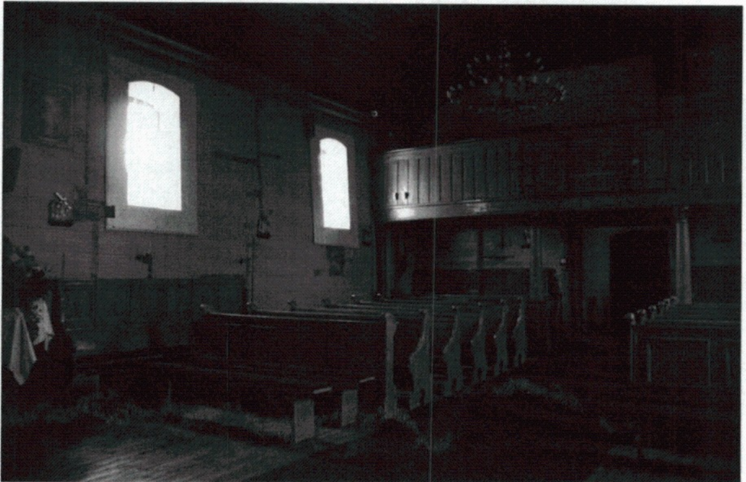
Fot. 5 Kościół pw. Św. Wawrzyńca w Mącznikach. Widok zniszczonej podłogi w nawie, przed konserwacją z lat 2017-19. Fot. Ewa Tymcik, 2017 r.
