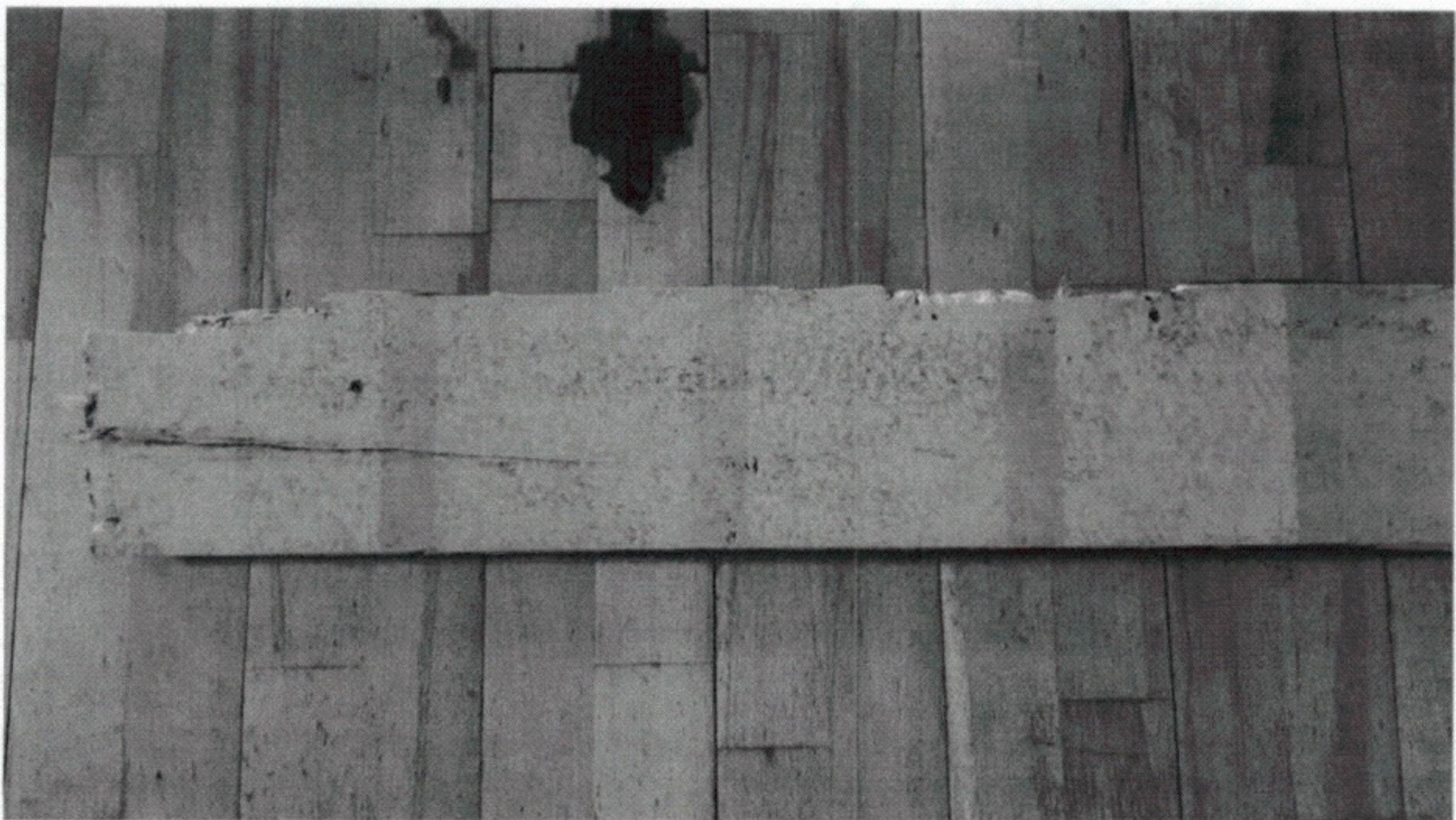
Fot. 8 Kościół pw. Św. Wawrzyńca w Mącznikach. Zbliżenie podłogi z deski barlineckiej w prezbiterium, widoczne przetarcia, zabrudzenia, oślepły lakier. Na podłodze położona deska z wykonanymi próbkami kolorystyki stropu. Fot. Ewa Tymcik, 2019 r.
