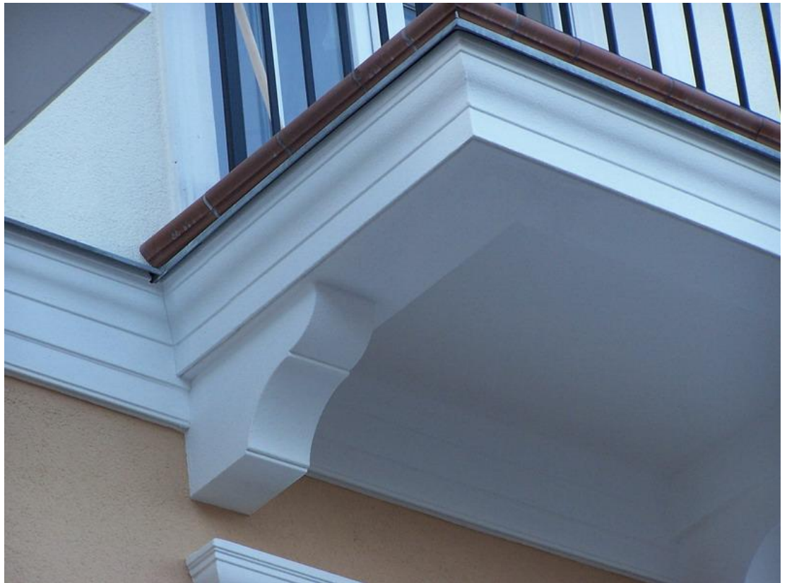
Zdjęcie nr 3 – Balkon – płyta spocznikowa.
