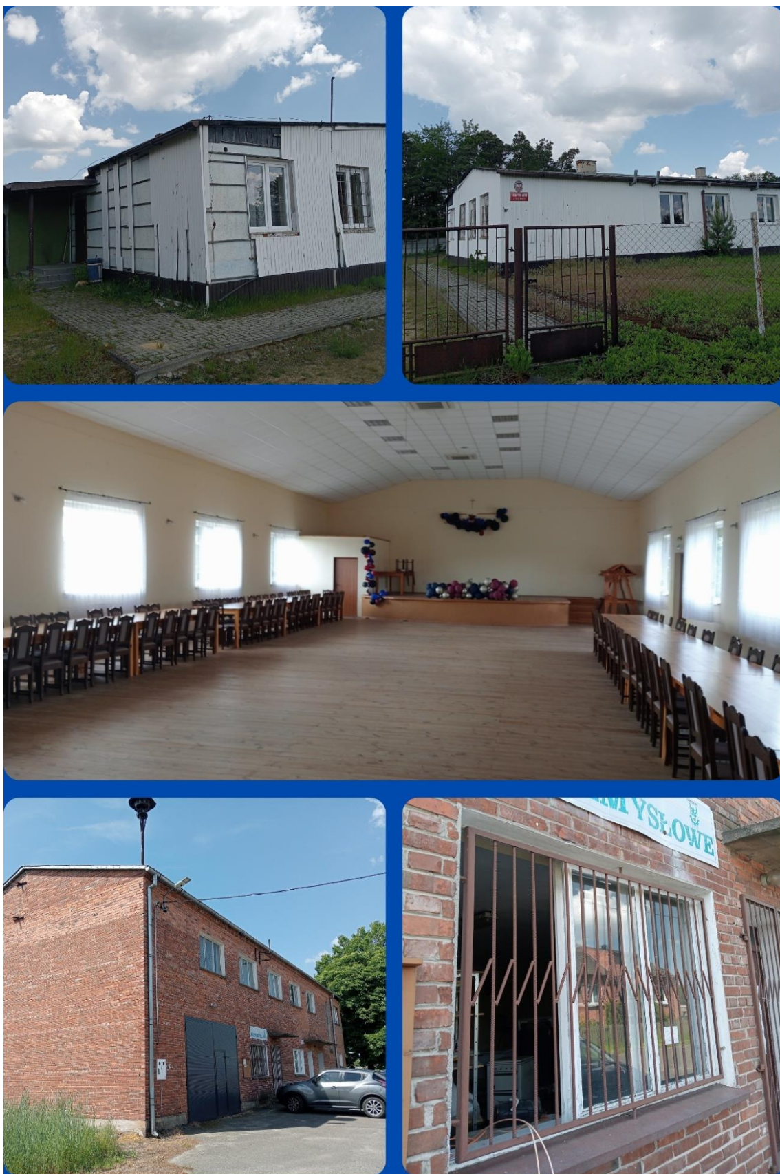
Rycina 11 Obiekty w złym stanie technicznym w miejscowościach: Dziecióły, Piegonisko-Wieś oraz Zagórna
