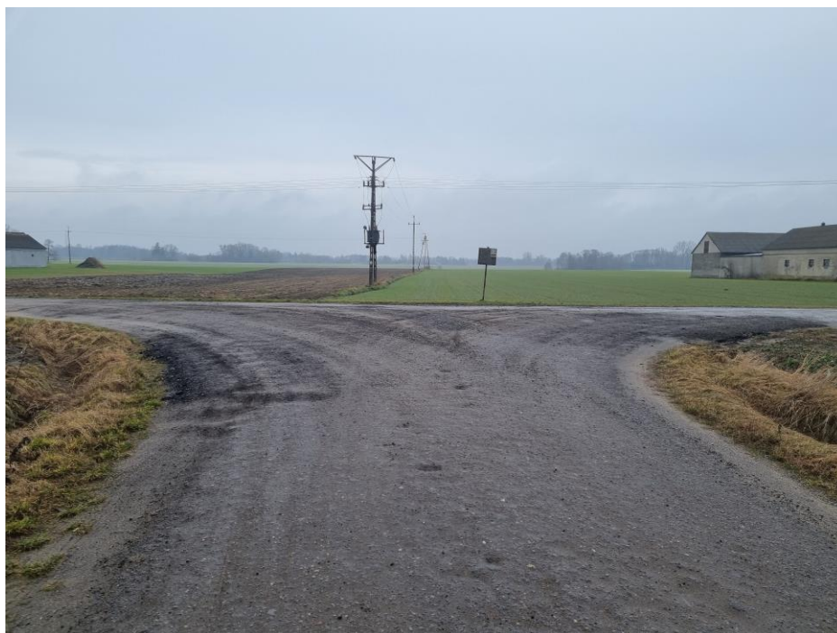
Zarośnięty rów w km +010 dcinku drogi.
