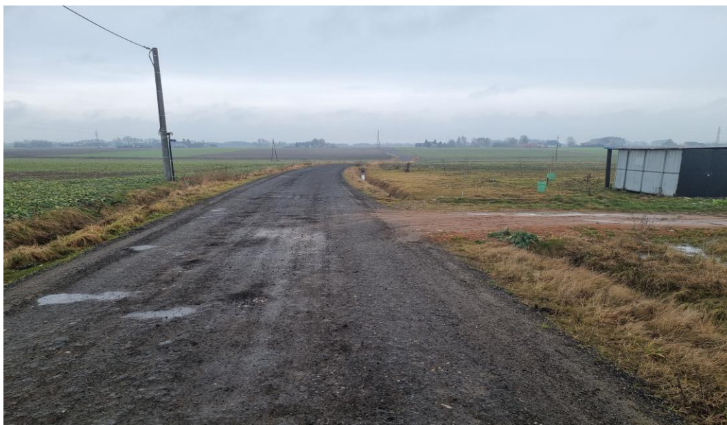
Zarośnięty rów lewy i prawy.
