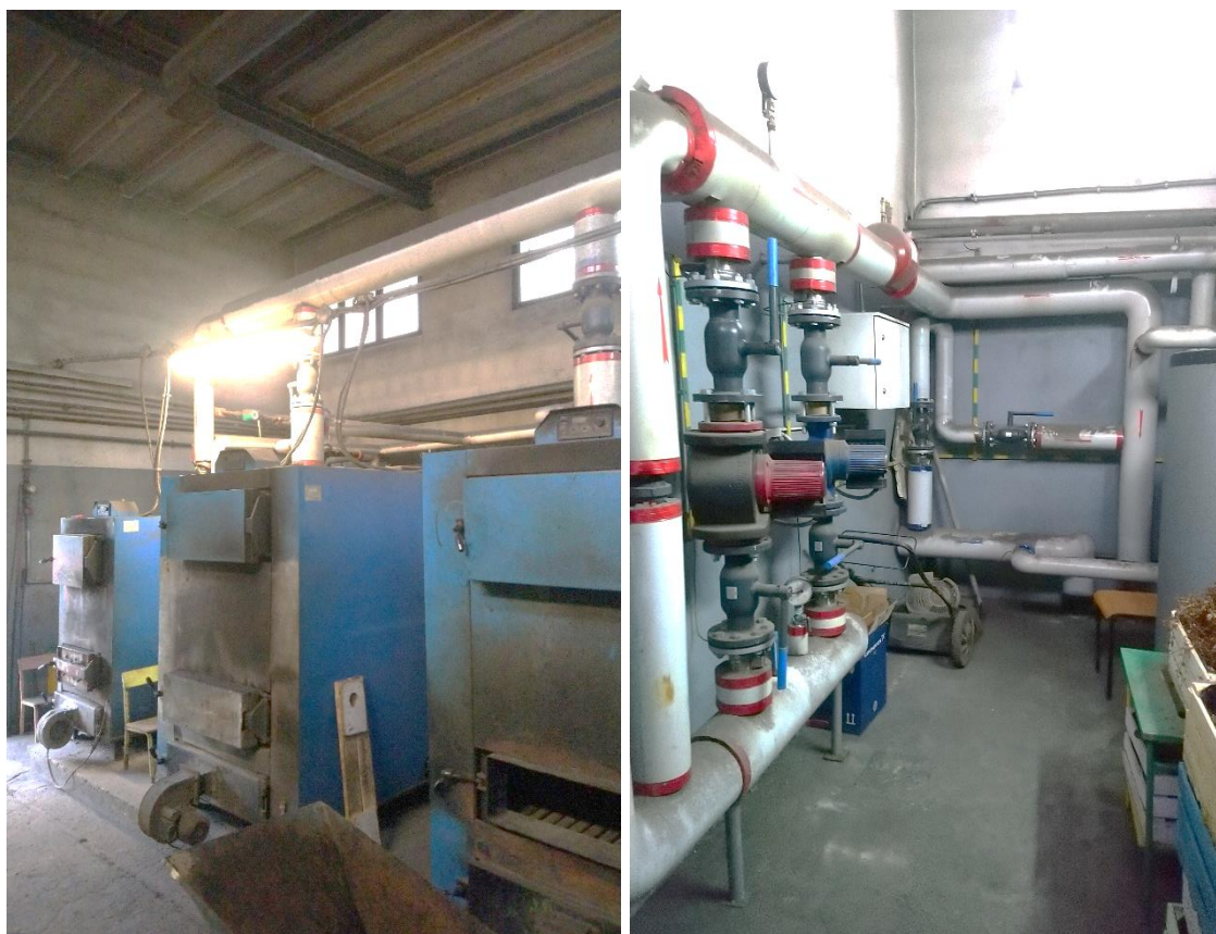
Fot. 5. Wnętrze kotłowni i pompowni CWU (listopad 2020)
