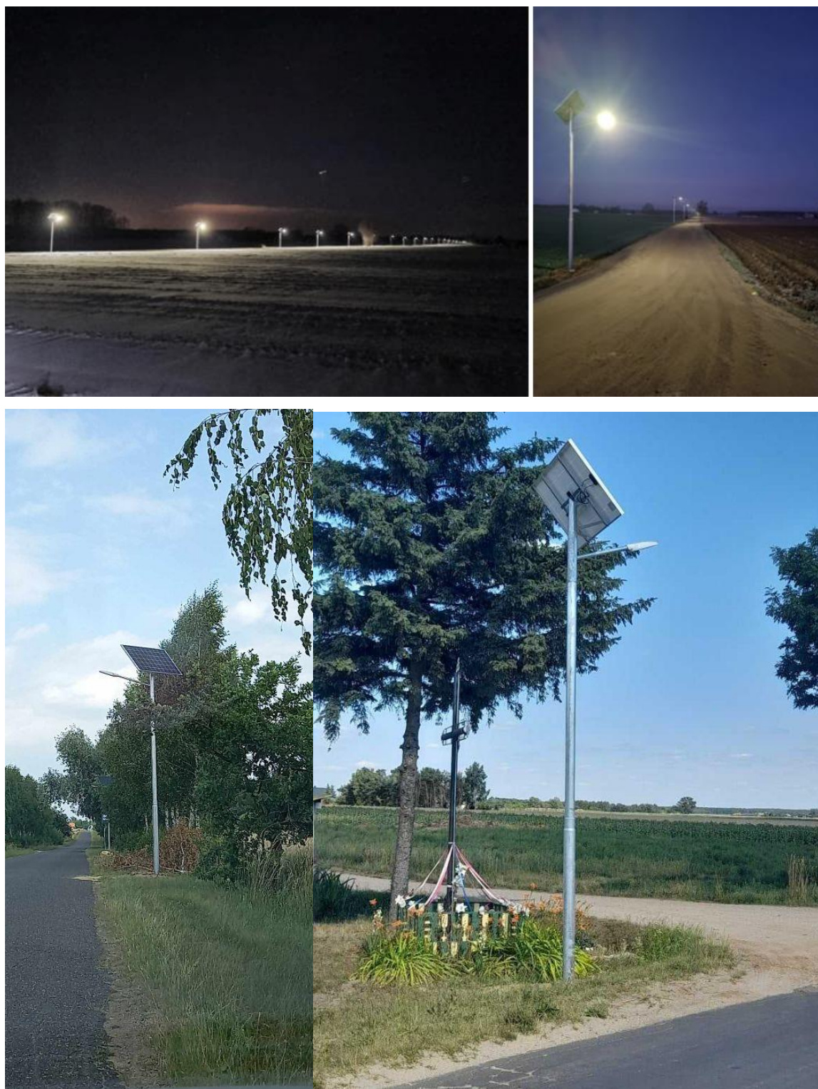
Zdjęcie 30-33. Solarne Lampy LEDowe zrealizowane w ramach zadania „Budowa oświetlenia zewnętrznego z własnym źródłem zasilania w Gminie Staroźreby”
