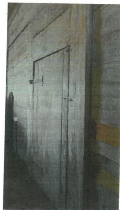
fot. 33 Kościół pw. św. Marcina w Linówcu wnętrze kościoła - drzwi na chórze przeznaczone do wymiany na nowe
