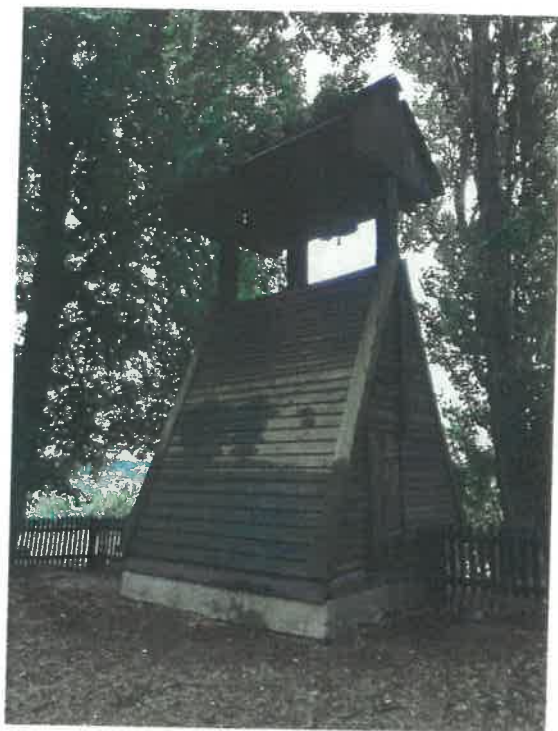
fot. 26 Zabytkowa dzwonnica przy kościół pw. św. Marcina w Linówcu widoczne zwiłgowacenie cokołu, uszkodzone deskowanie
