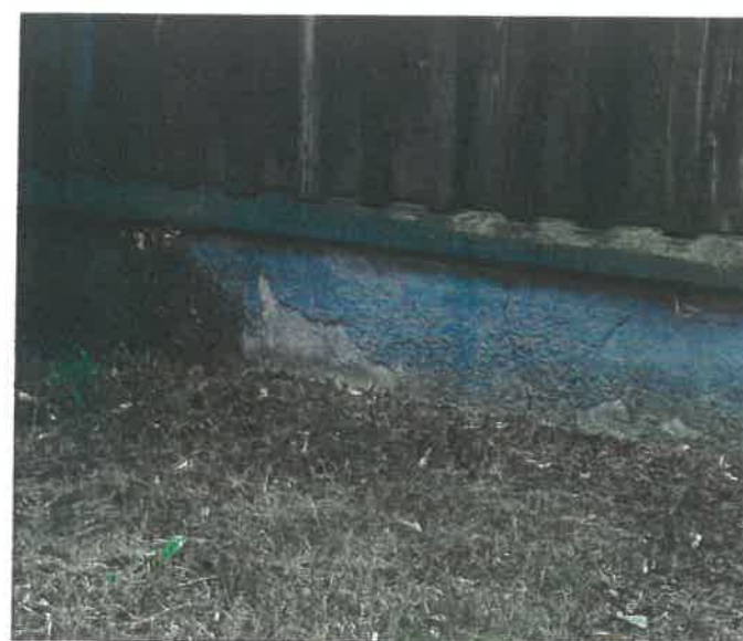
fot. 16 Kościół pw. św. Marcina w Linówcu liczną pęknięcia cokołu oraz widoczne zwilgowacenie
