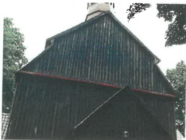
fot. 7 Kościół pw. św. Marcina w Linówcu detale snycerskie w obrębie elewacji frontowej, widoczne porażenia deskowania zewnętrznego
