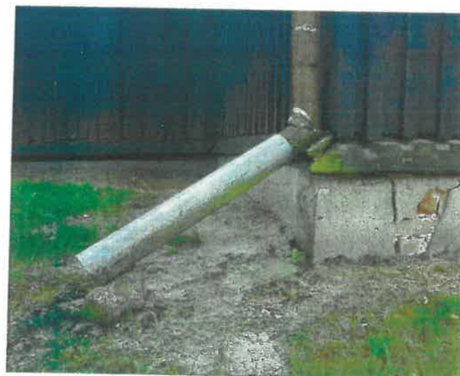
fot. 21 Kościół pw. św. Marcina w Linówcu uszkodzona deska okapowa oraz widoczne pęknięcia cokołu (pierwotny cokół ceglany z opaską betonową)
