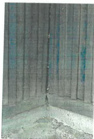
fot. 20 Kościół pw. św. Marcina w Linówcu uszkodzona deska okapowa oraz widoczne uszkodzenia w deskowaniu zewnętrznym
