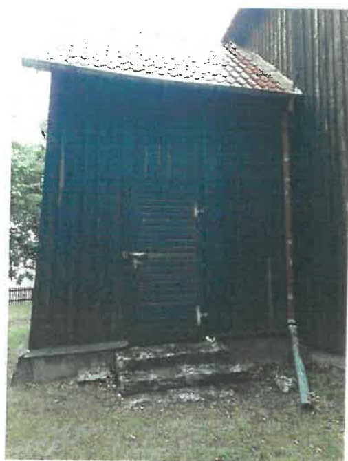
fot. 8 Kościół pw. św. Marcina w Linówcu wejście do pomieszczenia Zakrystii, widoczne uszkodzenia schodów oraz cokołu
