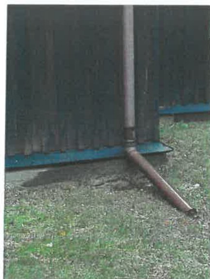
fot. 15 Kościół pw. św. Marcina w Linówcu uszkodzone systemy rynnowe prowadzące do zwilgowacenia cokołu
