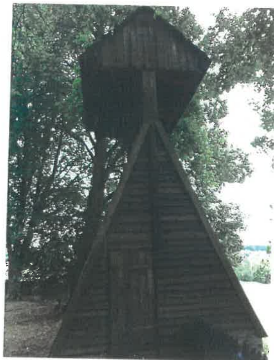
fot. 27 Zabytkowa dzwonnica przy kościół pw. św. Marcina w Linówcu widoczne uszkodzone deskowanie oraz ubytki w pokryciu
