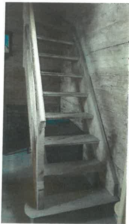
fot. 34 Kościół pw. św. Marcina w Linówcu wnętrze kościoła -schody na chór przeznaczone do kompleksowej konserwacji
