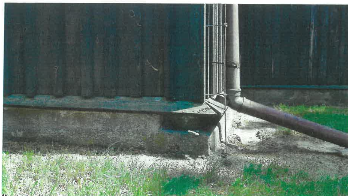
fot. 17 Kościół pw. św. Marcina w Linówcu liczną pęknięcia cokołu oraz widoczne ubytki
