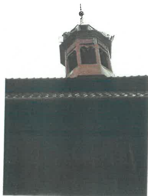
fot. 11 Kościół pw. św. Marcina w Linówcu widok na wieżę i połacie dachowe— ubytki pokrycia dachowego oraz widoczne uszkodzenia elementów konstrukcyjnych
