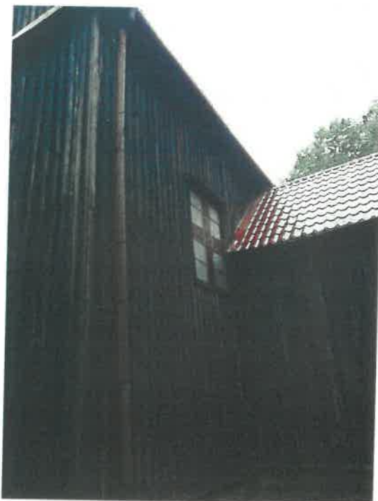
fot. 18 Kościół pw. św. Marcina w Linówcu istniejąca stolarka okienna, uszkodzenia instalacji odgromowej
