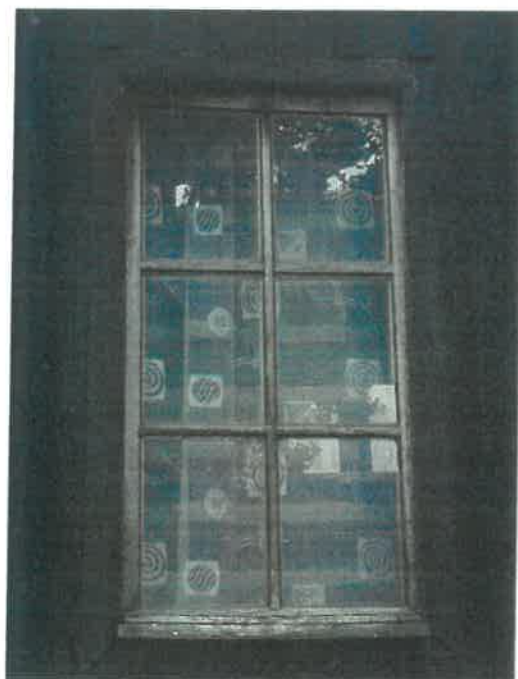
fot. 24 Kościół pw. św. Marcina w Linówcu istniejąca stolarka okienna(Zakrystia)
