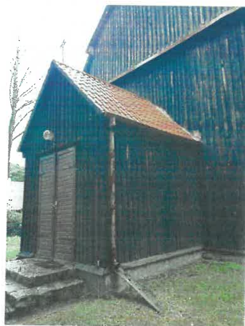
fot. 14 Kościół pw. św. Mikołaja w Czeszewie drzwi wejściowe do kruchty, widok na schody frontowe, uszkodzone systemy rynnowe oraz uszkodzenia cokołu
