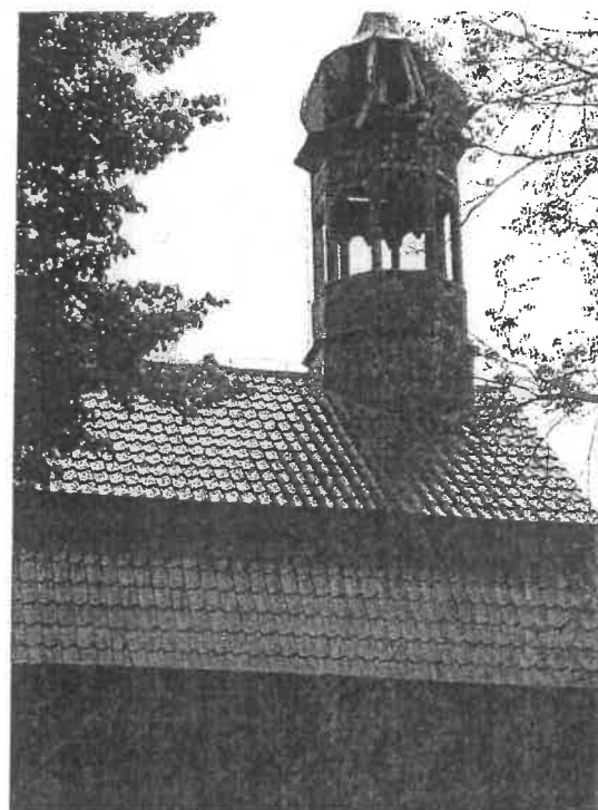
fot. 10 Kościół pw. św. Marcina w Linówcu z widokiem na uszkodzoną wieżę - ubytki pokrycia dachowego oraz widoczne uszkodzenia elementów konstrukcyjnych
