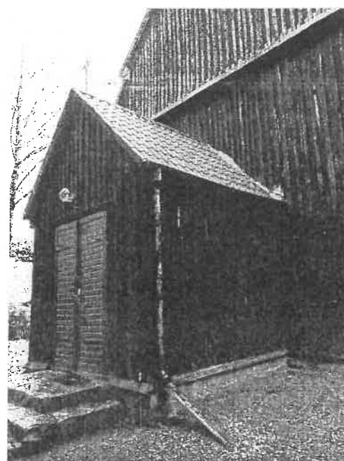
fot. 14 Kościół pw. św. Mikołaja w Linówcu drzwi wejściowe do kruchty, widok na schody frontowe, uszkodzone systemy rynnowe oraz uszkodzenia cokołu
