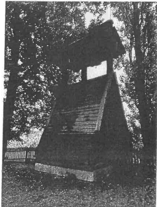
fot. 26 Zabytkowa dzwonnica przy kościele pw. św. Marcina w Linówcu widoczne zwiłgowanie cokołu, uszkodzone deskowanie
