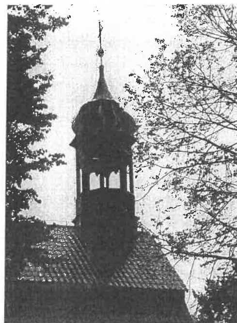
fot. 12 Kościół pw. św. Marcina w Linówcu fragmenty uszkodzonej wieży i połaci dachowych- ubytki pokrycia dachowego oraz widoczne uszkodzenia elementów konstrukcyjnych
