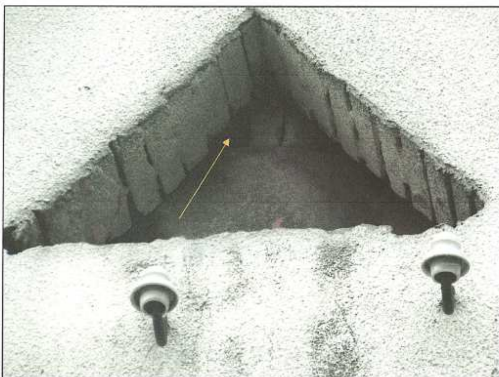
Fot. 8. Rozogi Przedszkole – szczyt wschodni. Niezabezpieczone okienko na strychu – wejście do miejsca łęgowego 2–3 par kawek.
