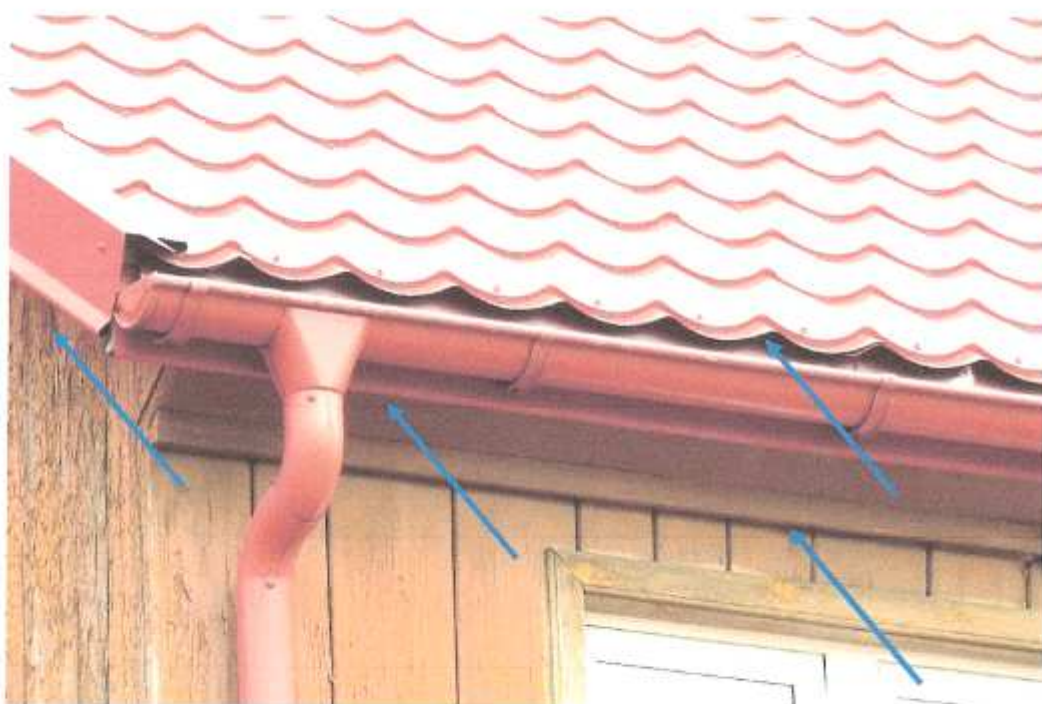
Fot. 3. Zbliżenie lukarny, strzałkami zaznaczono potencjalne kryjówki nietoperzy.
