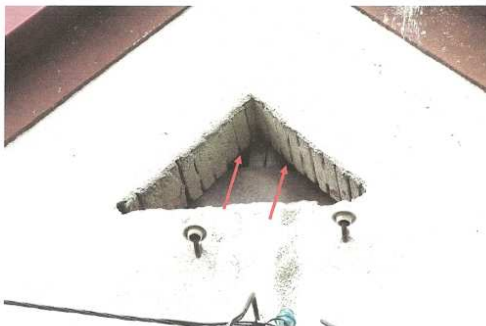
Fot. 6. Częściowo zabezpieczony otwór okienny ze szczelinami prowadzącymi do wnętrza strychu.
