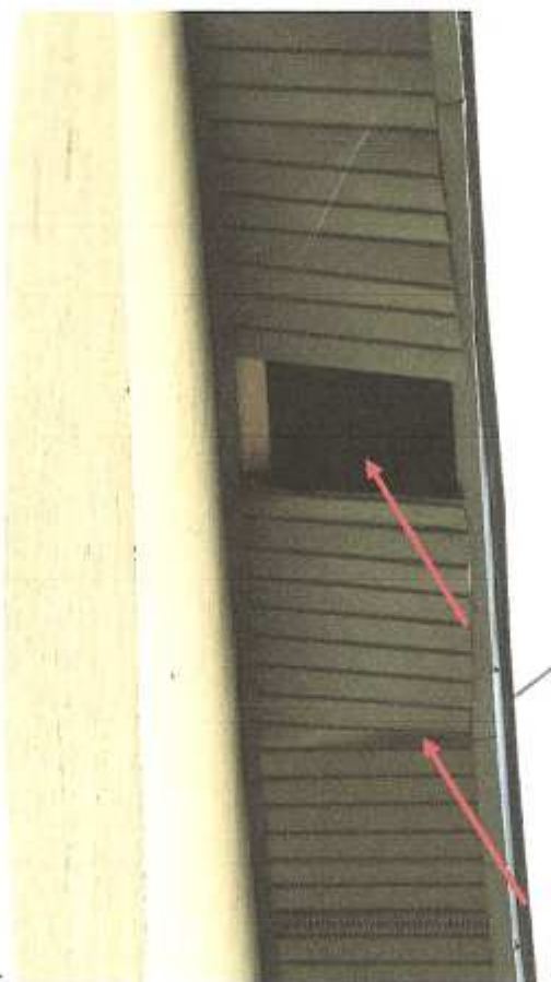
Fot. 4. Ubytki w podbitce dachu.
