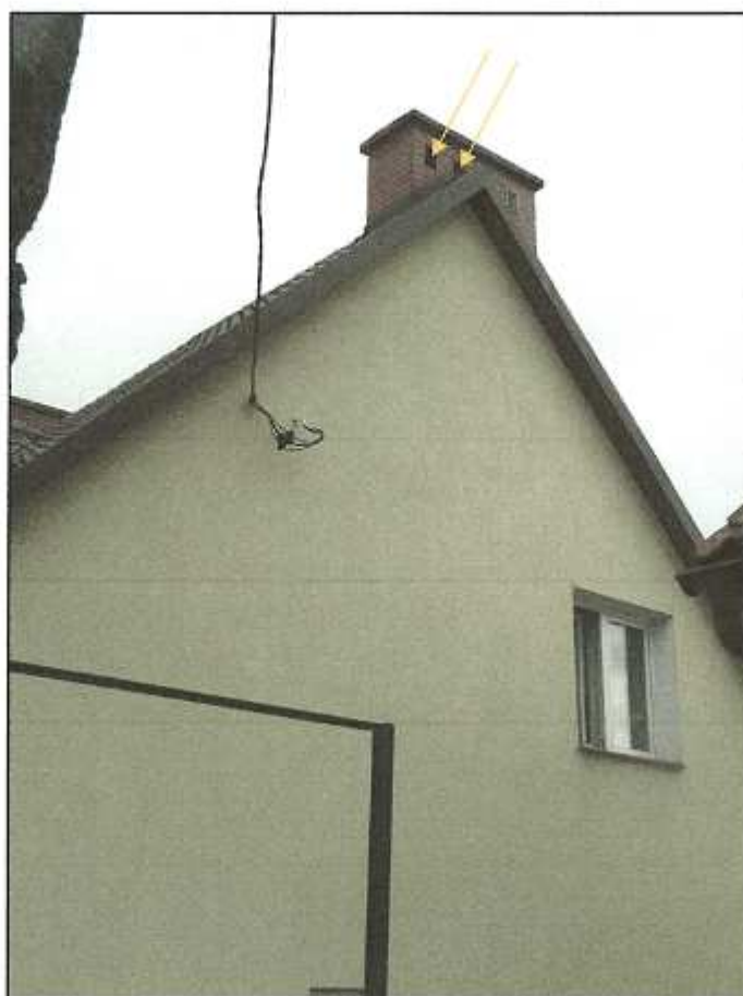
Fot. 8. Urząd Gminy w Rozogach. Dwa niezabezpieczone wywietrzniki – potencjalne lęgi dwóch par kawek.
