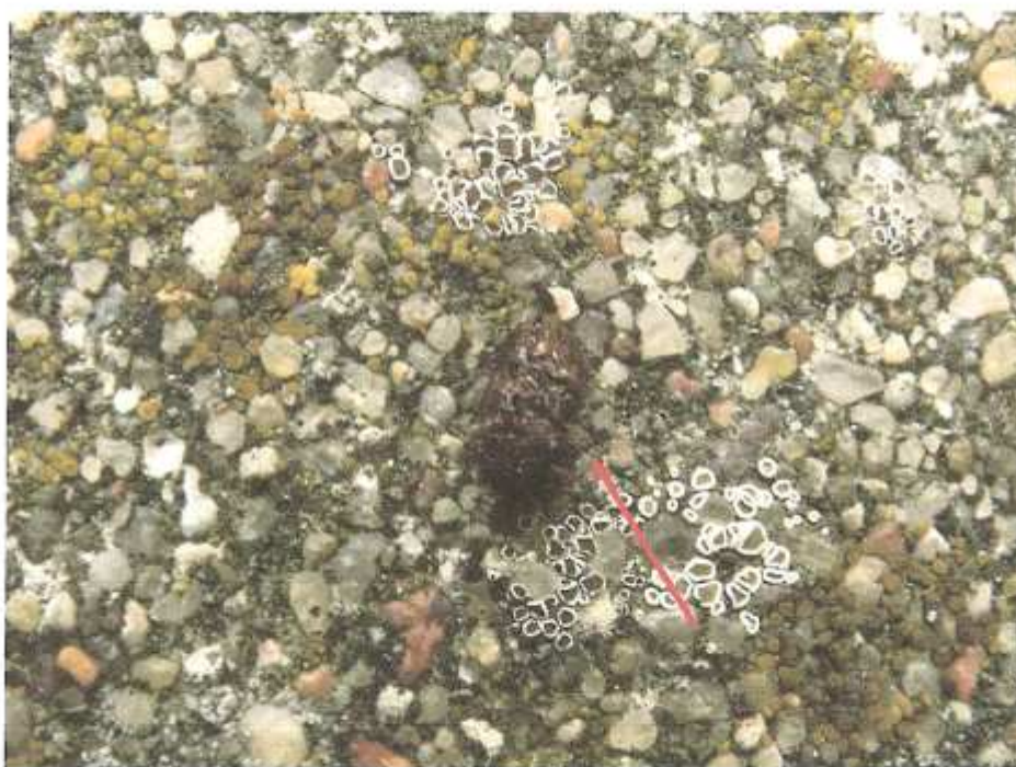
Fot. 6. Odchody nietoperzy na chodniku przy budynku UG, poniżej otworu widocznego na zdjęciu 4.
