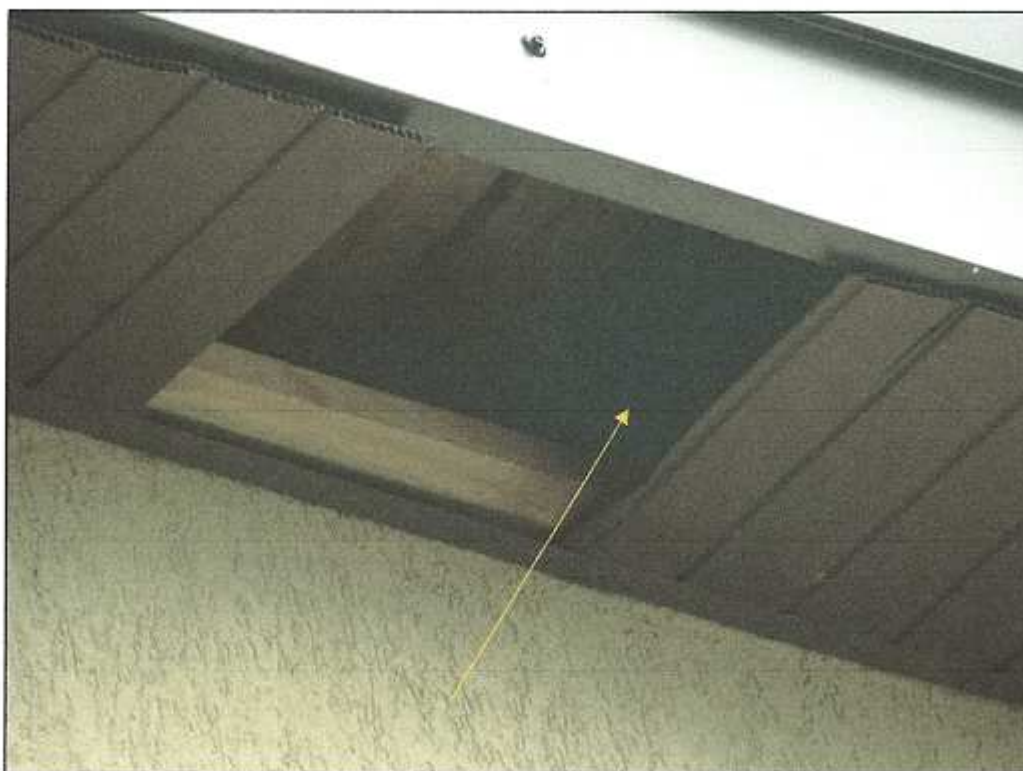
Fot. 4. Urząd Gminy w Rozogach Ubytek 4 elementów – powstała wnęka jest miejscem potencjalnego lęgu kawki.
