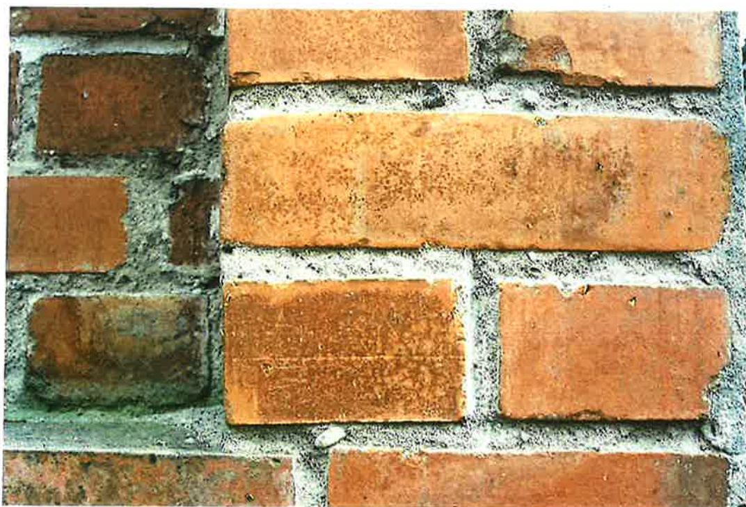
Spoiny na elewacji północnej. Jedyne miejsce gdzie zidentyfikowano miękkie, wapienne spoiny. Prawdopodobne jest, że są oryginalne. Świadczy o tym bardzo urozmaicone, nieprzesicwane kruszywo. Na spoinach zaobserwować można nawet drobne kamyki. Ponadto, tynk widoczny przy prawej krawędzi został częściowo zatarty na spoiny. Świadczy to o tym, że jest późniejszy.
