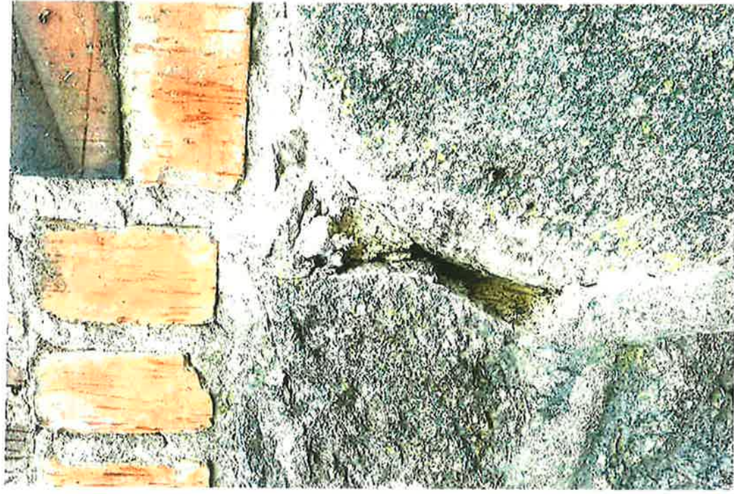
Fragment kamiennego cokołu od strony południowej. Ze szczyliny pomiędzy kamieniami wydobyto bardzo kruche, rozsypujące się w dłoń, spoiwo – glinę zmieszaną z piaskiem. Spoiny kamieni wykonano z zaprawy cementowej.
