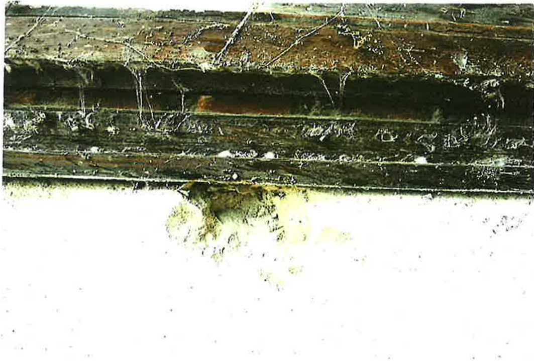
Odkrywka wewnątrz frontowej niszy. Cementowo-wapienny tynk jest całkowicie wtórny. Jego krawędzie są bardzo twarde i równe. Okno także wtórne, dobrze spasowane.
