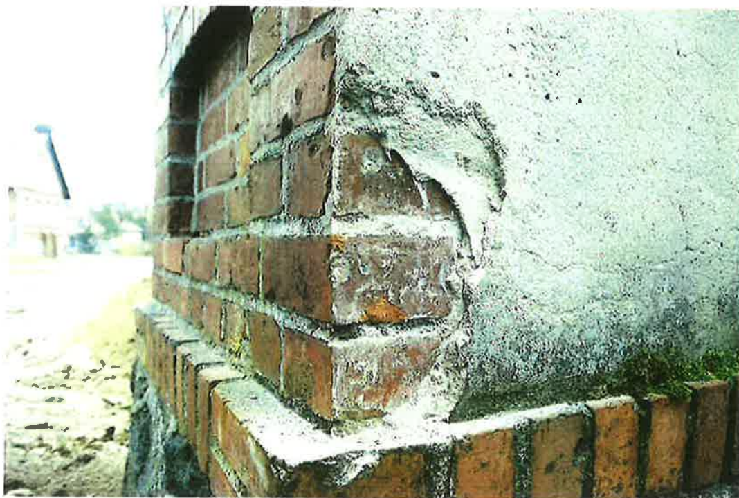
Odkrywka na tylnej elewacji. Cementowo wapienny tynk na elewacji frontowej został zatarty podczas jednego z wielu remontów kapliczki.
