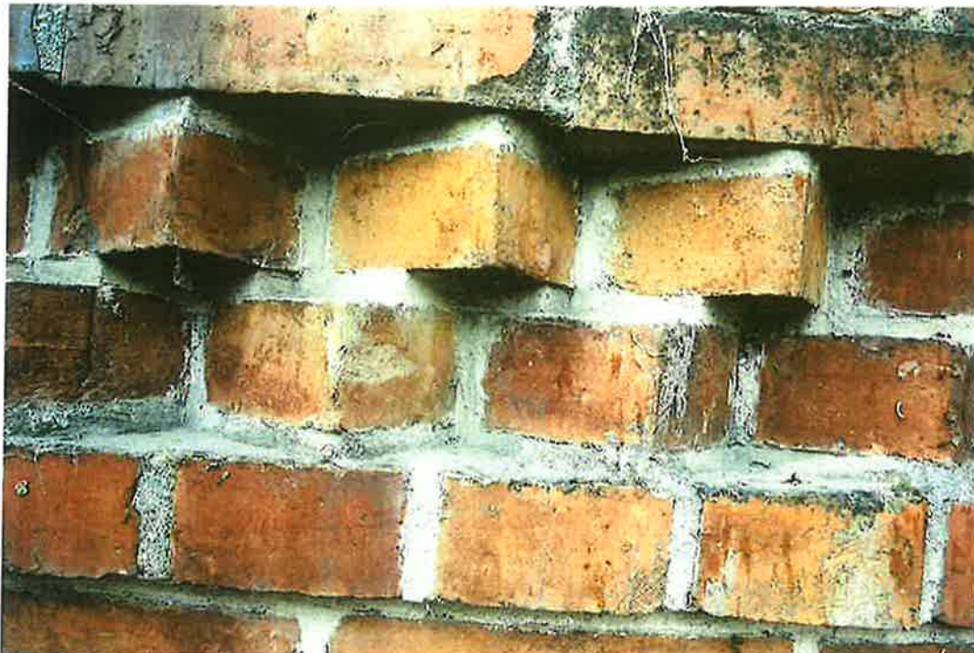
Wtórne spoiny zatarte na skośnym fryzie ząbkowym. Spoiny są wyraźnie jaśniejsze, o drobniejszym kruszywie, miejscami zatarte z nadmiarem i bardzo wyostrzone na krawędziach. Prawdopodobnie wykonano je podczas ostatniego remontu, kilka lat
