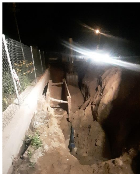
Awaria sieci wodociągowej w m. Bogusze
