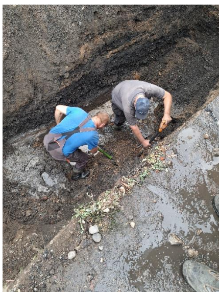
Awaria sieci wodociągowej w m. Prostki.
