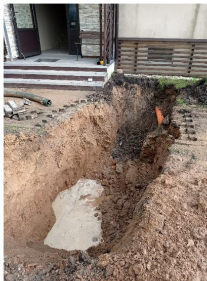
Awaria przyłącza wodociągowego w m. Bobry.
