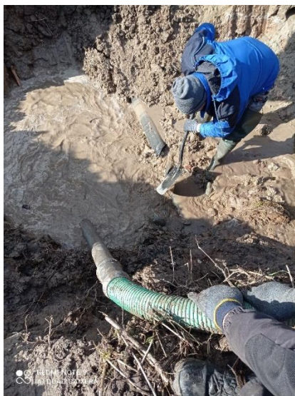
Awaria sieci wodociągowej w m. Rożyńsk Wielki.
