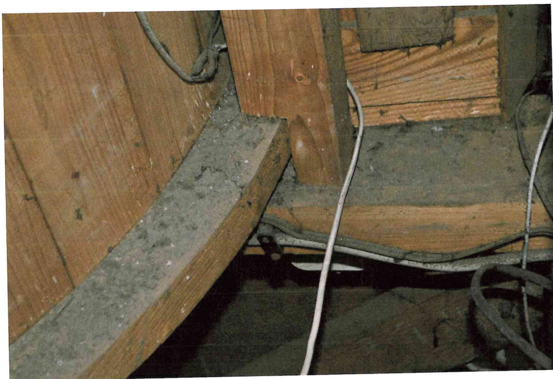
Fot. 22. Ołtarz główny przed konserwacją, fragment. Widoczny kurz i okablowanie.
