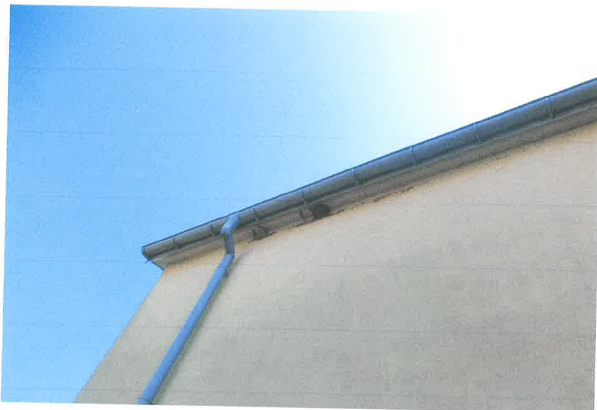
Gniazdo oknówki nr 5 na sali gimnastycznej, od strony ul. Siedleckiej
