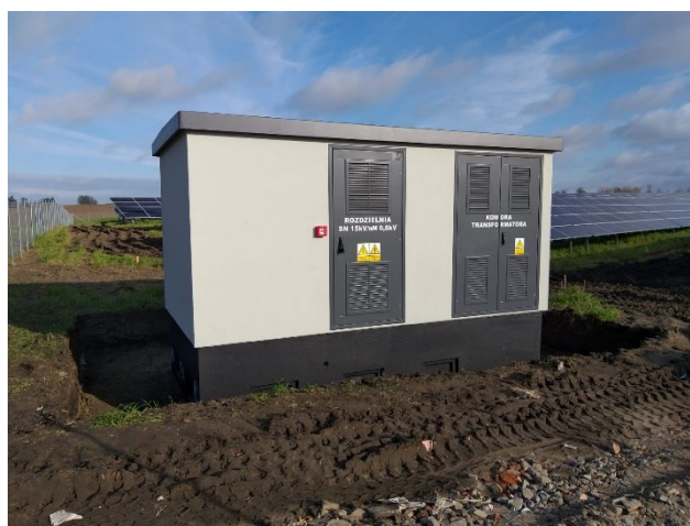
Fot. 3 Stacja transformatorowa kontenerowa z widocznymi w tle panelami oraz ogrodzeniem.
