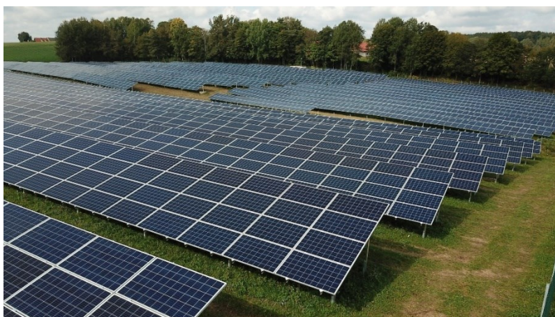
Fot. 2 Przykład rozmieszczenia modułów elektrowni PV. Materiały Wnioskodawcy.
