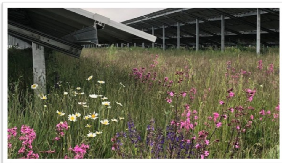
Fot. 13 Przestrzeń między rzędami paneli PV porośnięta roślinnością zielną. Autor: Christina Grätz, nagolare
