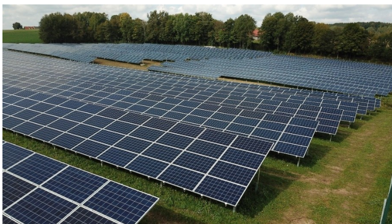
Fot. 12 Przykład rozmieszczenia modułów elektrowni PV. Materiały Wnioskodawcy.
