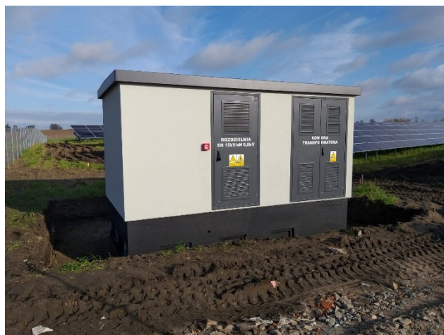
Fot. 3 Stacja transformatorowa kontenerowa z widocznymi w tle panelami oraz ogrodzeniem.
