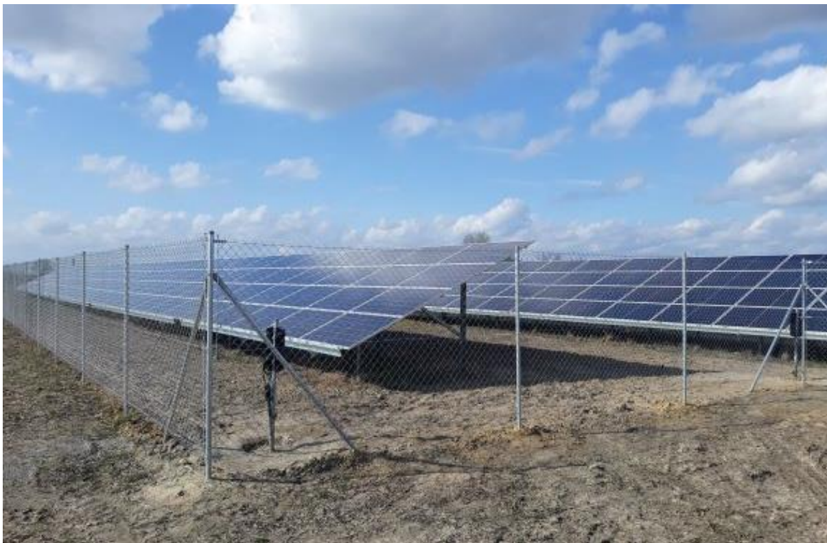
Rycina 9. Przykładowe ogrodzenie farmy fotowoltaicznej.
