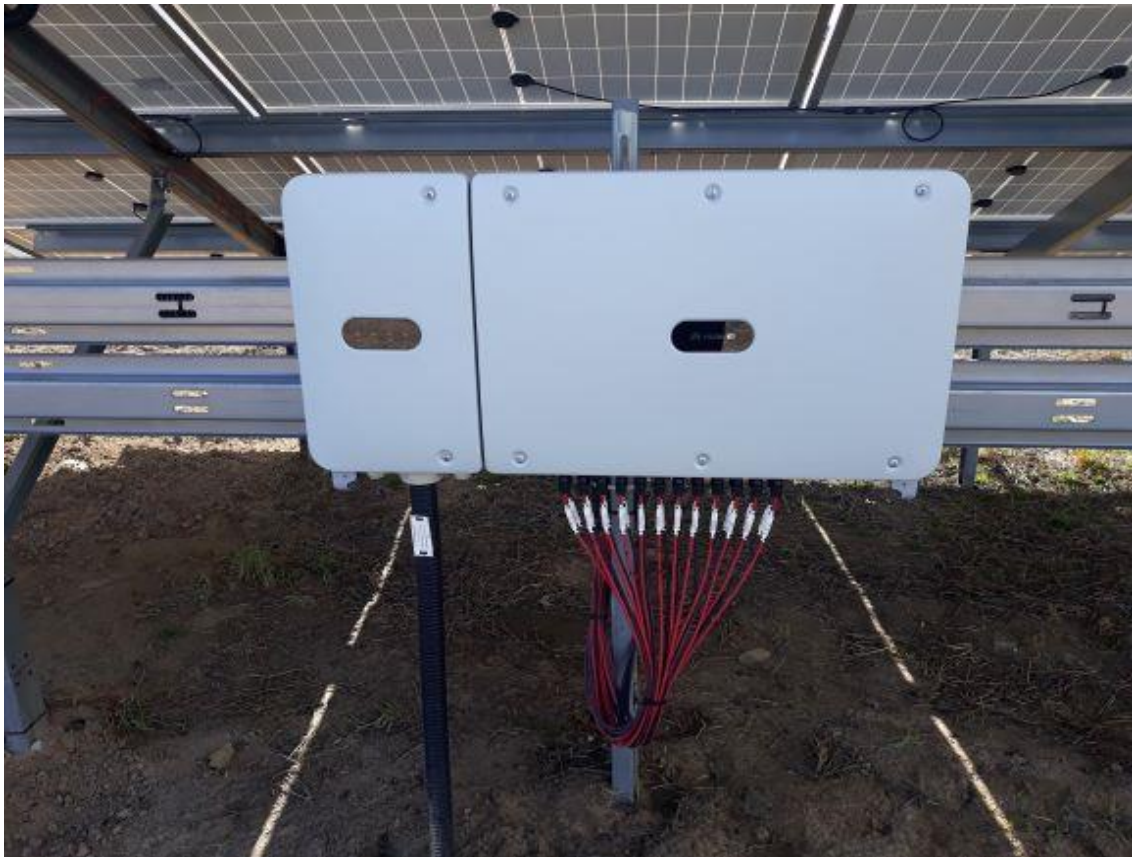
Rycina 7. Przykładowy inwerter farmy fotowoltaicznej.
