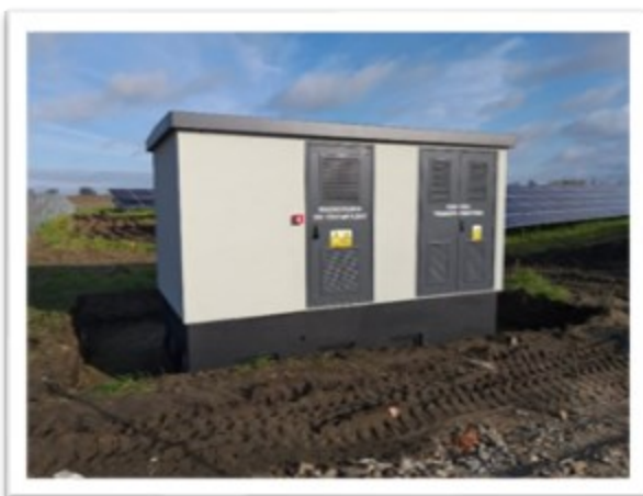
Fot. 3 Stacja transformatorowa kontenerowa z widocznymi w tle panelami oraz ogrodzeniem. Materiały wnioskodawcy.
