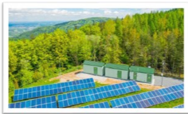
Fot. 5 Magazyn energii na Górze Żar. Źródło PGE
