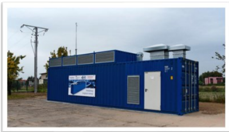
Fot. 4 Magazyn energii litowo - jonowy w okolicach Pucka. Źródło Energa.
