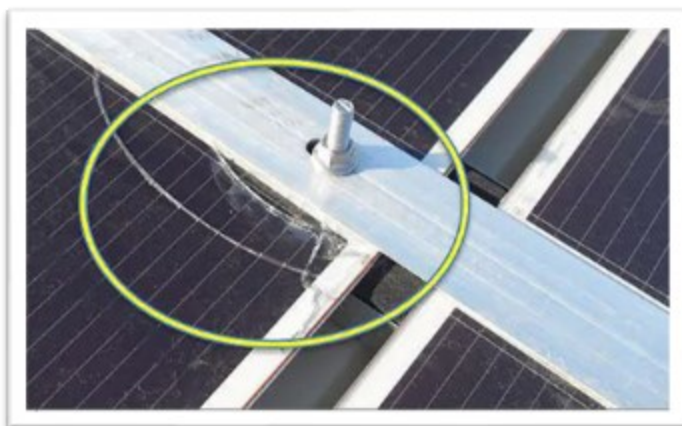
Rysunek 48 Przykład pęknięcia powłoki panelu PV. IEA International Energy Agency, Review of Failures of Photovoltaic Modules - Report IEA-PVPS T13-01:2014
