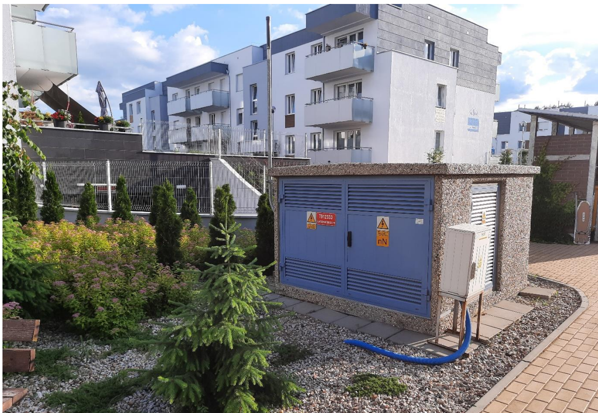
Rycina 11. Stacje transformatorowe w otoczeniu zabudowy mieszkaniowej.
