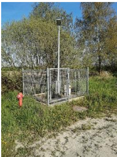
Przepompownia ścieków w Micharzewie
