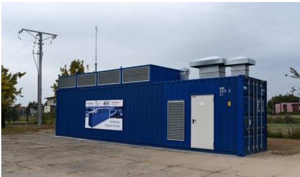
Ryc. 9. Przykładowy magazyn energii
