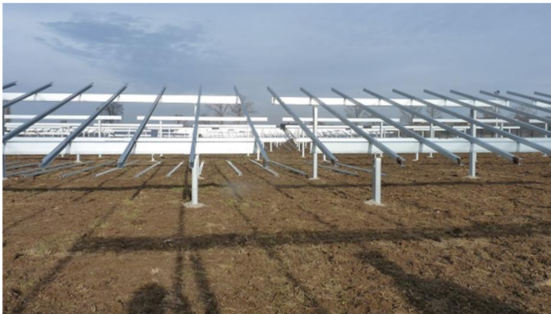
Fot. 2 Konstrukcja stalowa stelaży pod moduły fotowoltaiczne
