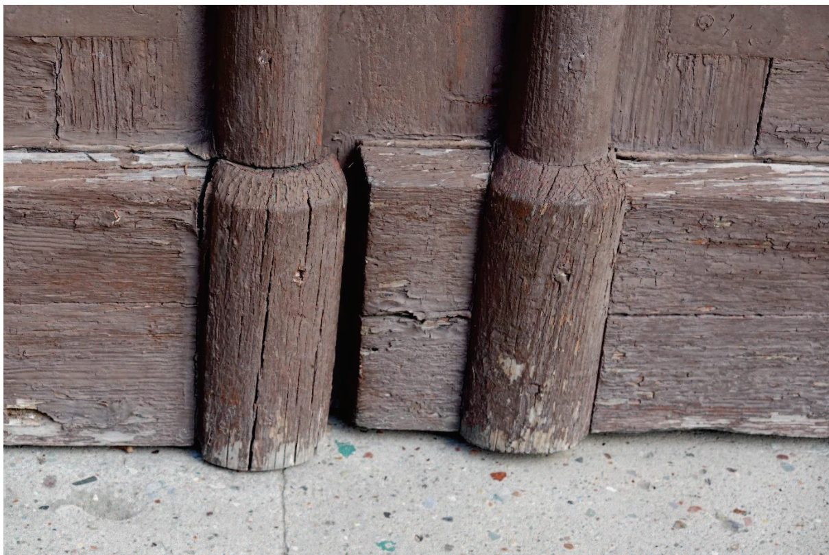
↑Fot. Powyżej: Detale drzwi głównych ozn. Dz 1 - do kościoła – do renowacji
