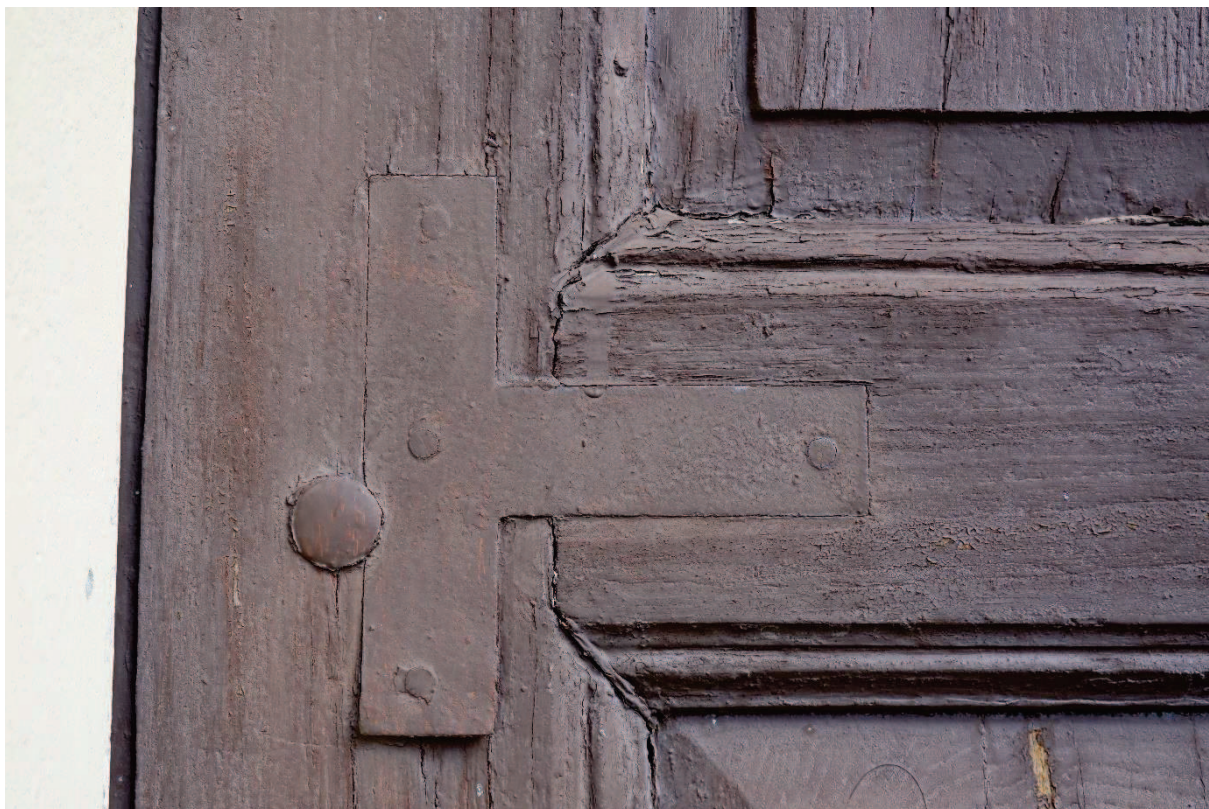
↓Fot. Poniżej: Detale drzwi głównych ozn. Dz 1 - do kościoła – do renowacji
