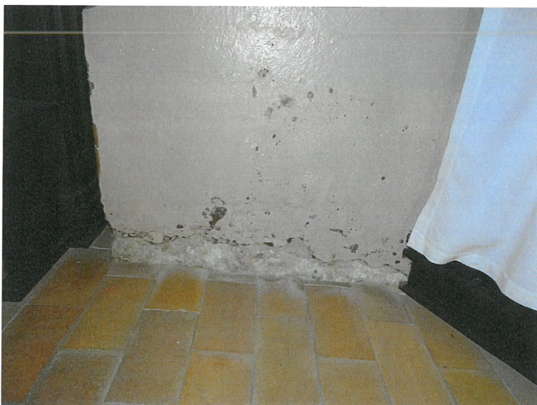
Fot. 14 Zniszczenia wywołane zasoleniem i zawilgoceniem
