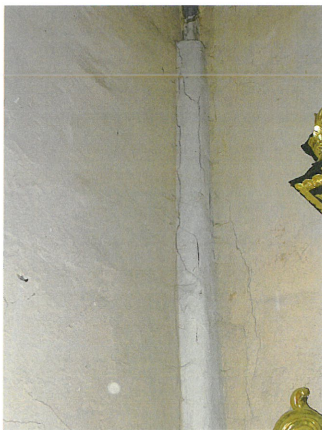
Fot. 22 Zarysowania i włoskowate spękania ścian
