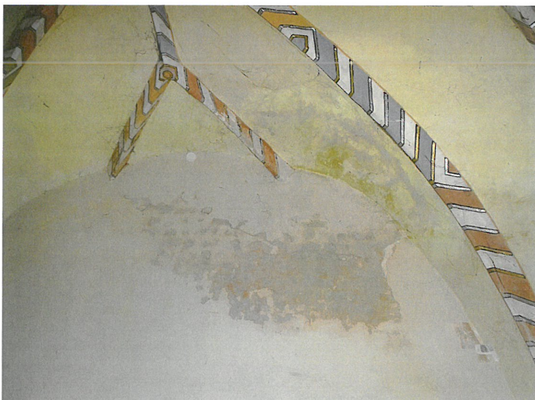
Fot. 32 Rdzawo - brunatne plamy po zaciekach i zawilgoceniach
