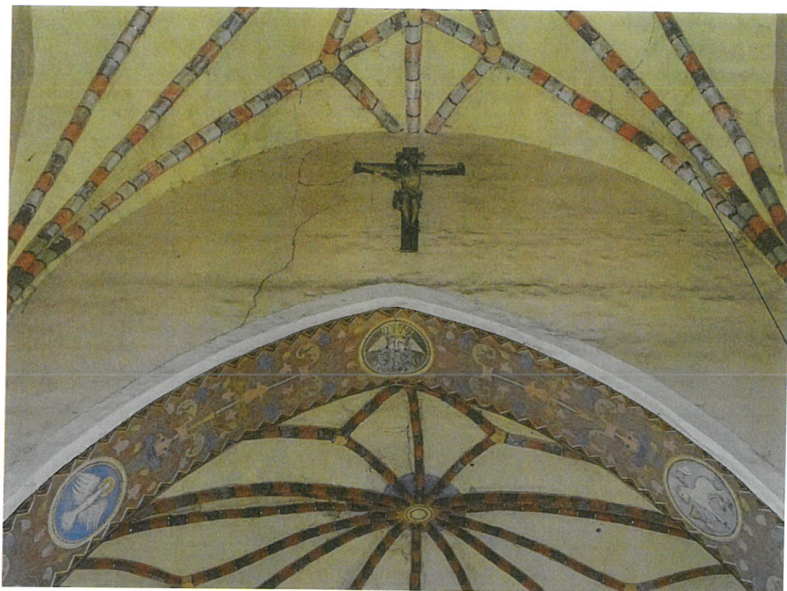
Fot. 25 Zarysowania i włoskowate spękania ścian
