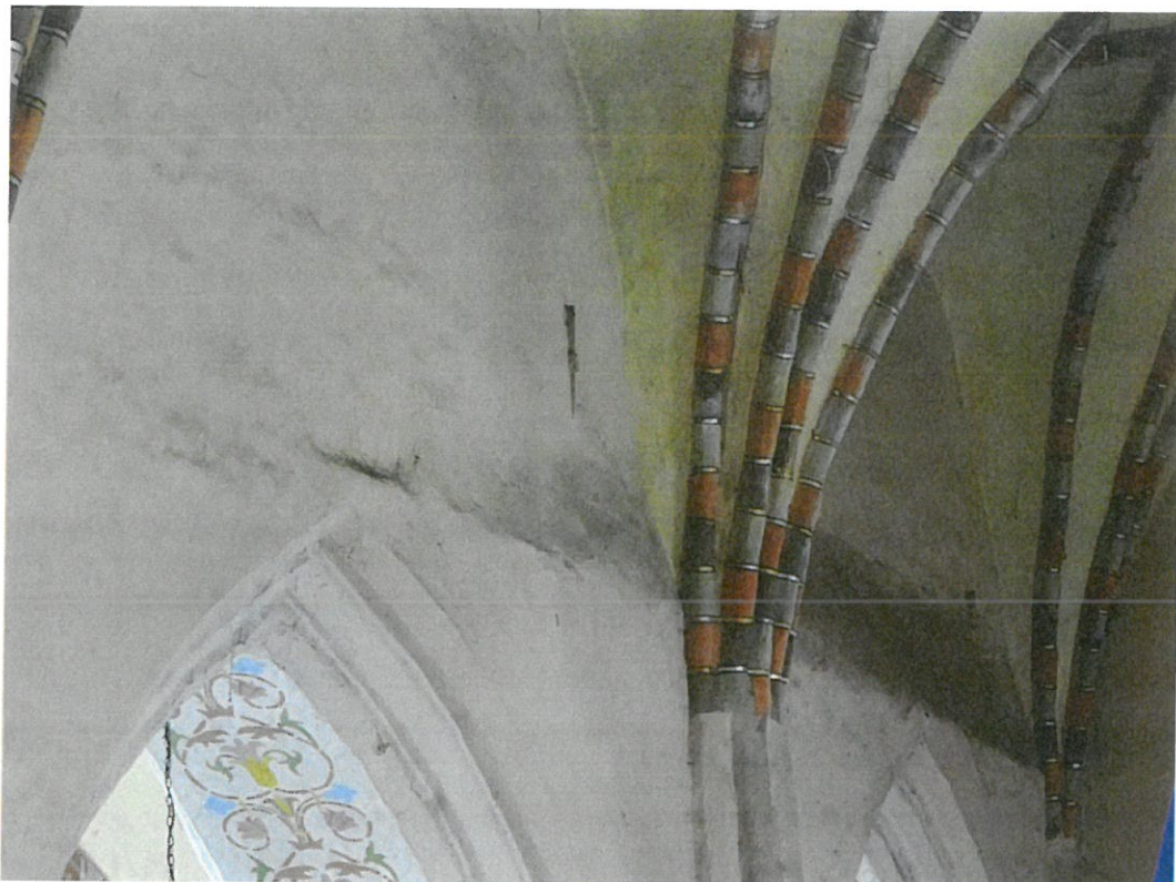
Fot. 1 Zabrudzona i zakurzona powierzchnia ścian i sklepień
