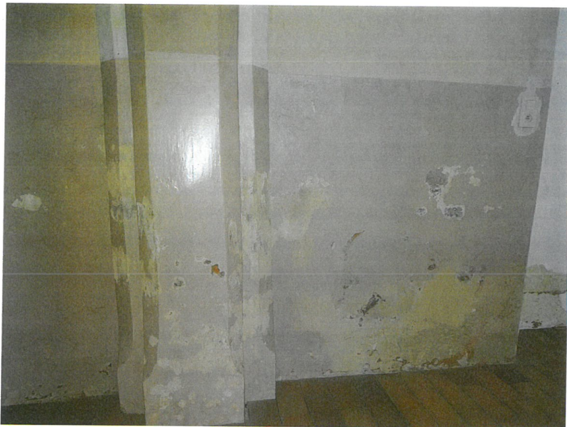
Fot. 5 Zły stan ścian w części przyziemia
