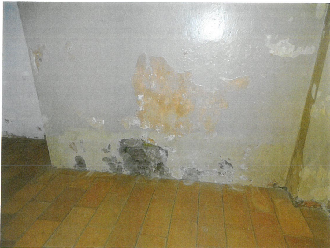
Fot. 11 Zniszczenia wywołane zasoleniem i zawilgoceniem
