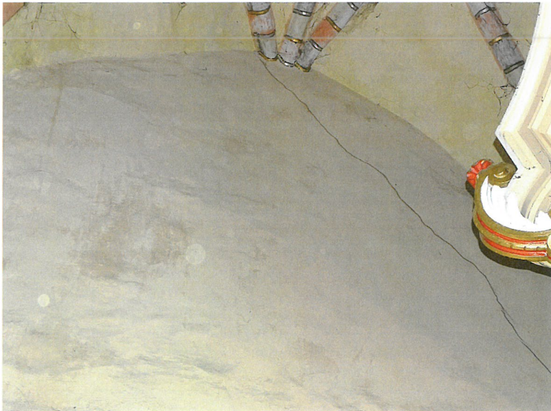
Fot. 24 Zarysowania i włoskowate spękania ścian
