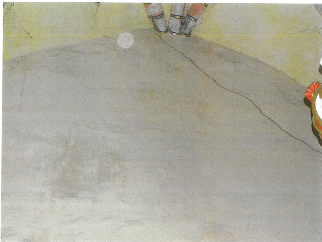
Fot. 33 Rdzawo - brunatne plamy po zaciekach i zawilgoceniach
