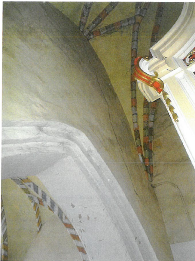
Fot. 29 Rdzawo - brunatne plamy po zaciekach i zawilgoceniach
