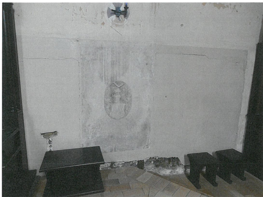
Fot. 20 Poziome i pionowe pęknięcia sugerujące prawdopodobieństwo występowania blend w głębokości muru
