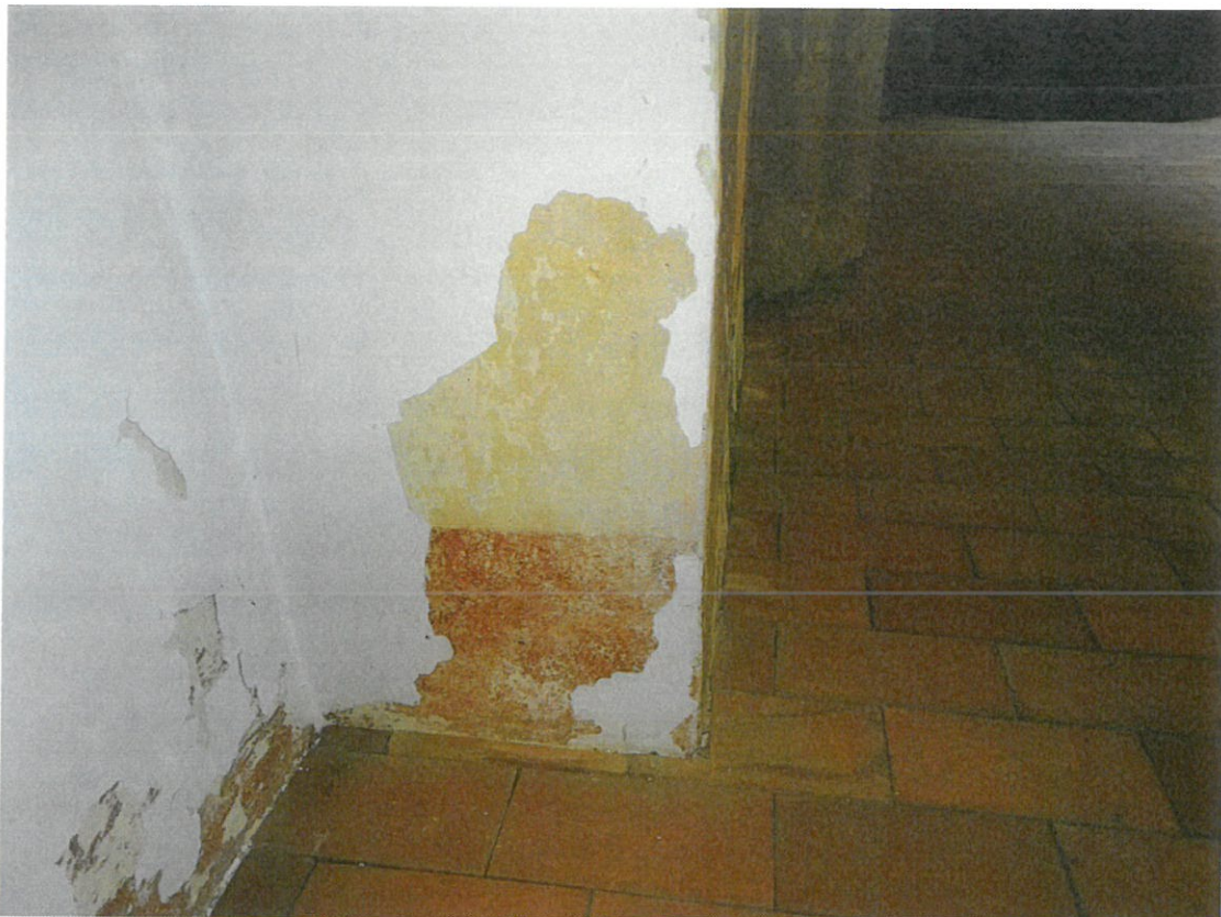
Fot. 13 Zniszczenia wywołane zasoleniem i zawilgoceniem
