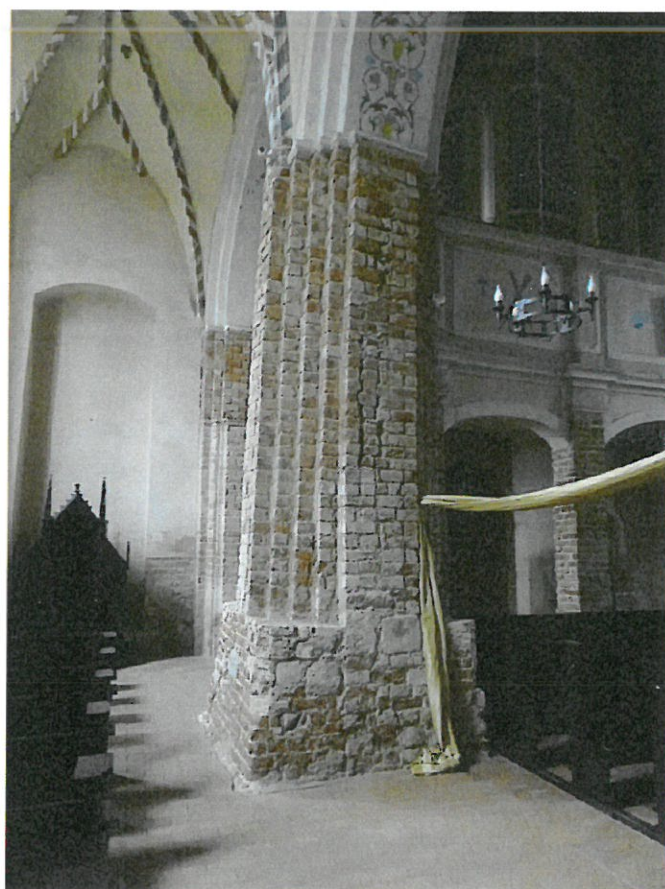
Fot.71 Widok filar międzynawowy z odsłoniętym wątkiem ceglany
