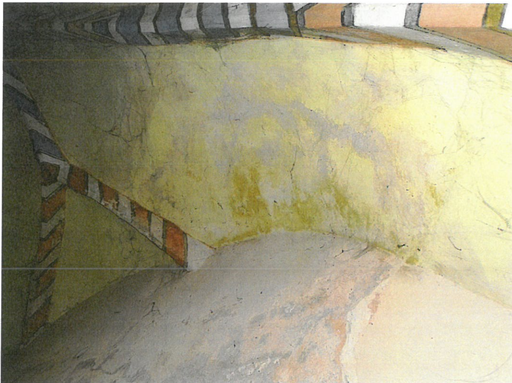
Fot. 31 Rdzawo - brunatne plamy po zaciekach i zawilgoceniach
