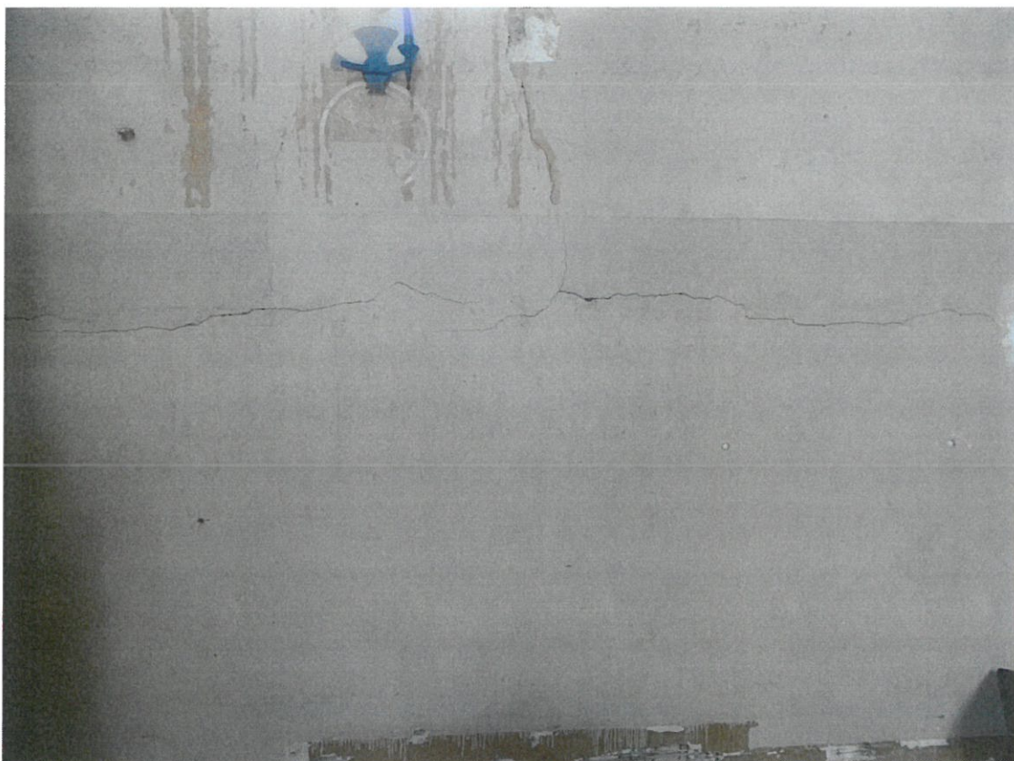
Fot. 19 Poziome pęknięcia sugerujące prawdopodobieństwo występowania blend w głębokości muru
