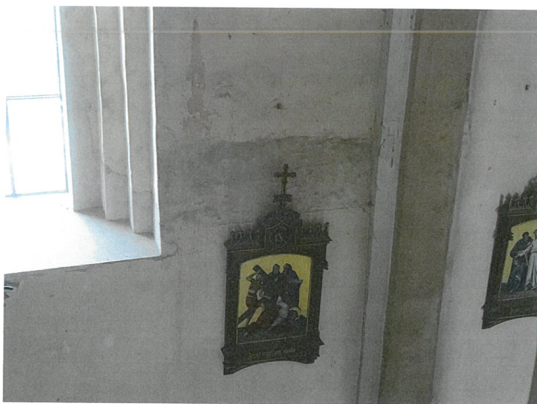
Fot. 6 Zły stan ścian w górnej części
