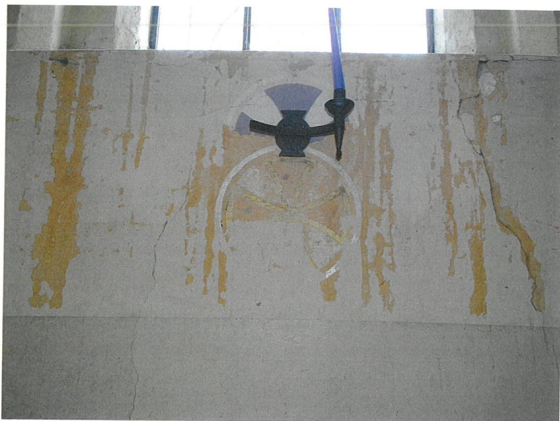
Fot. 26 Ślady po zaciekach pod parapetami okien
