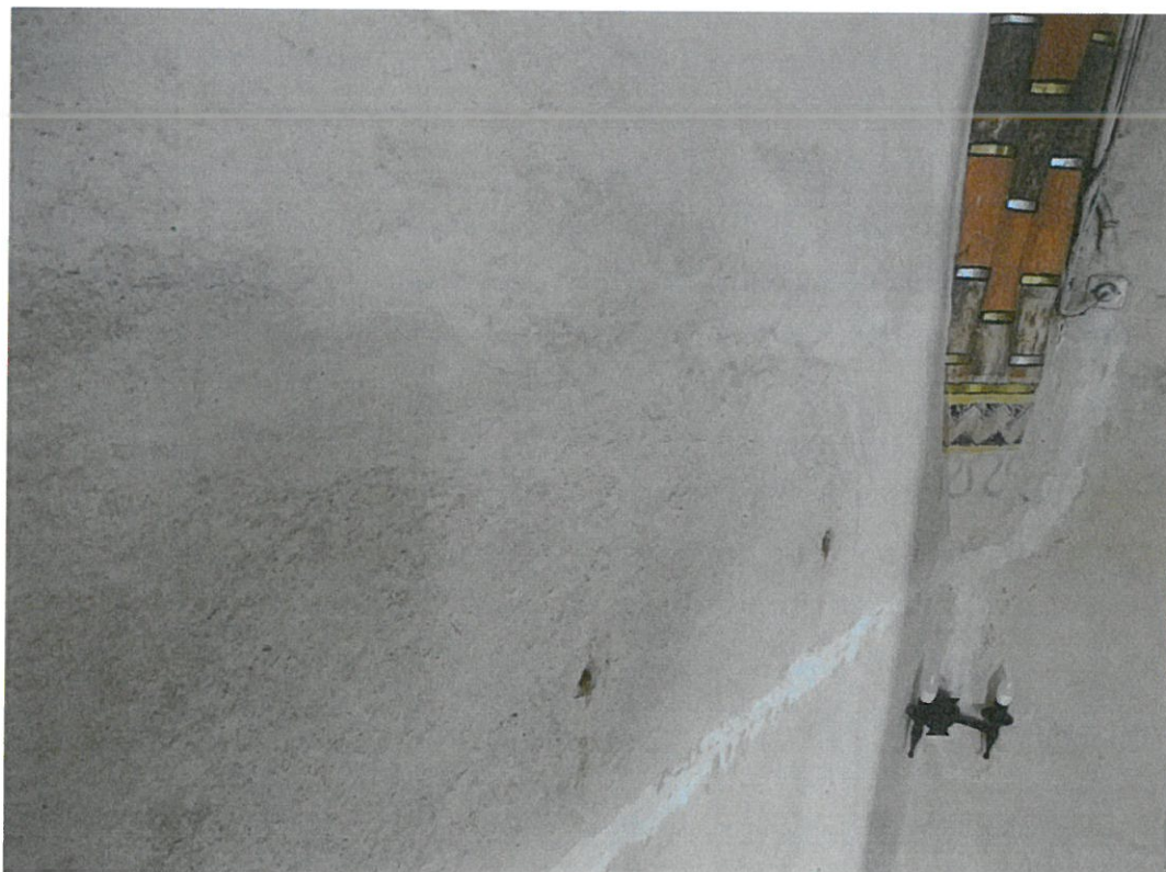
Fot. 2 Zabrudzona i zakurzona powierzchnia ścian i sklepień
