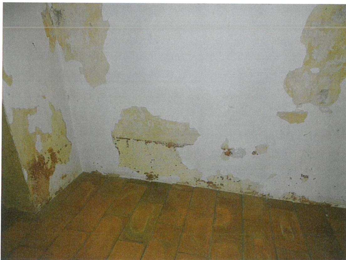
Fot. 12 Zniszczenia wywołane zasoleniem i zawilgoceniem
