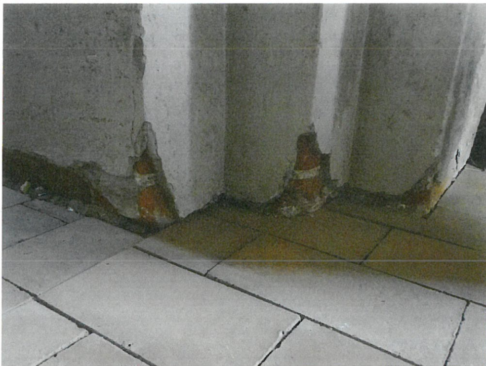
Fot. 21 Ubytki i uszkodzenia wywołane wymianą i naprawą posadzki
