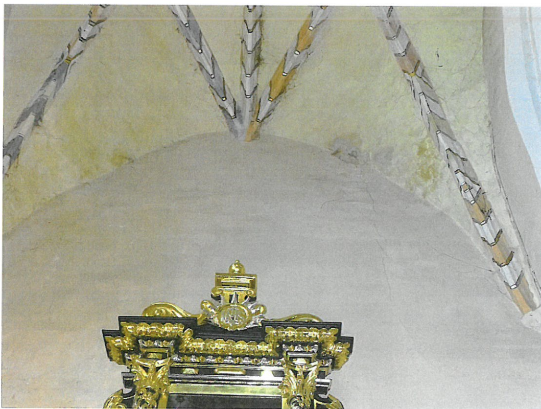
Fot. 28 Rdzawo - brunatne plamy po zaciekach i zawilgoceniach
