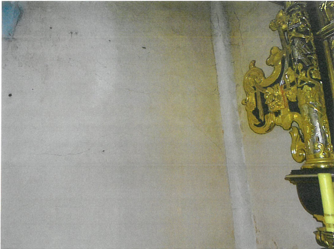
Fot. 23 Zarysowania i włoskowate spękania ścian
