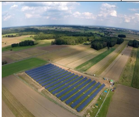
Elektrownia Jedwabne (0,71MW) 11
