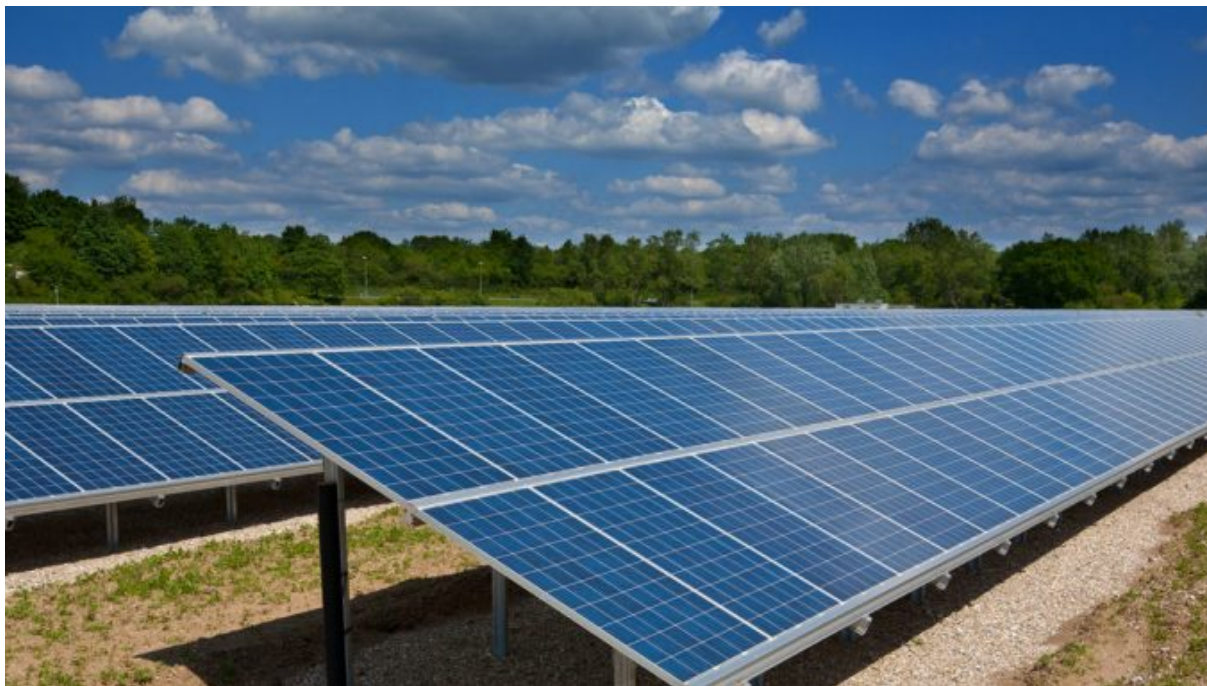
Ryc. 4. Przykładowa konstrukcja z panelami fotowoltaicznymi (źródło: http://jasionka24.pl/2019/02/17/farma-fotowoltaiczna-w-jasionce/ )
