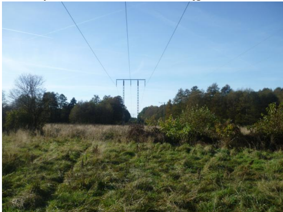
Fot. 5. Istniejąca linia 110 kV na terenie pomiędzy jeziorami Czekanowskim i Łęgowskim
