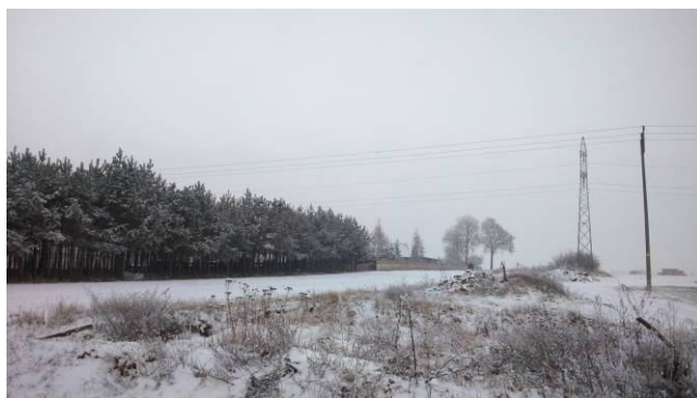
Linia wysokiego i średniego napięcia
