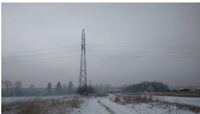
Konstrukcja wsporcza linii wysokiego napięcia
