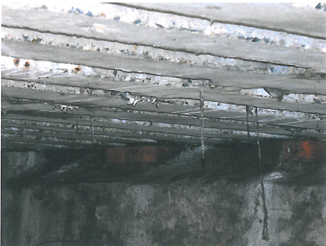
Fot. nr 18 – Rdzawe wykwity na powierzchniach bocznych belek. Nacieki z węglanu wapnia na spodzie belek i na korpusie przyczółka.
