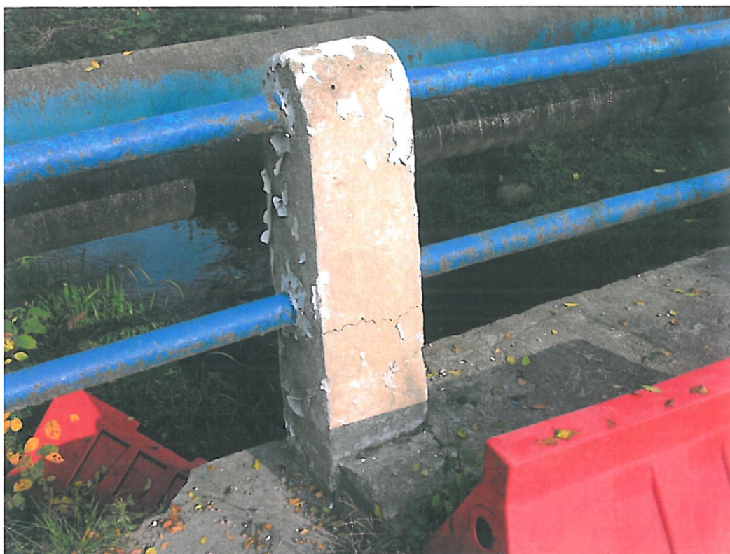
Fot. nr 7 – Pęknięcie poziome słupka balustrady od strony górnej wody.
