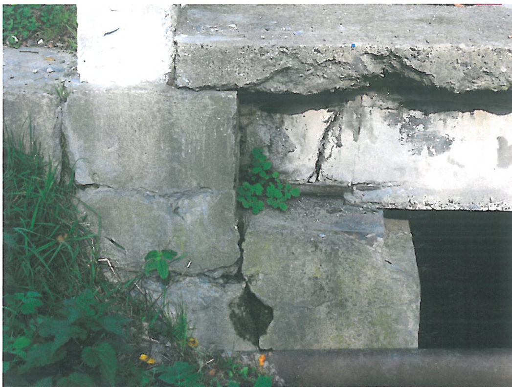
Fot. nr 19 – Pęknięcia korpusu przyczółka.
