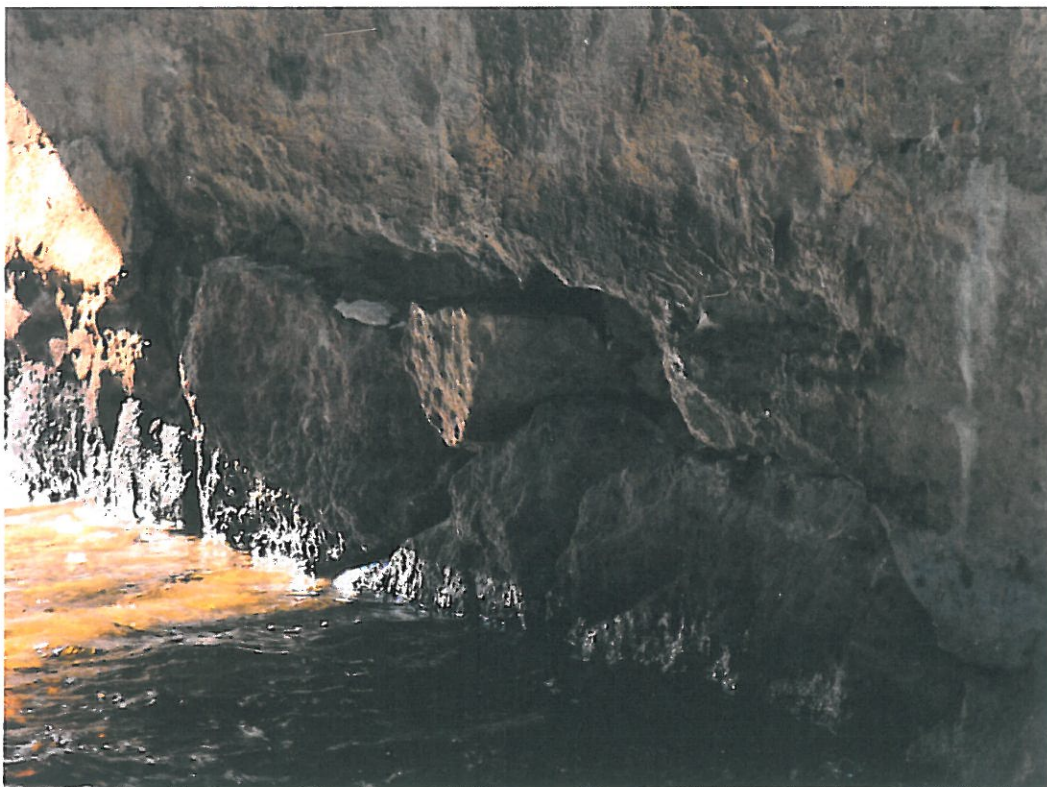
Fot. nr 20 – Ubytki betonu na korpusie podpory.
