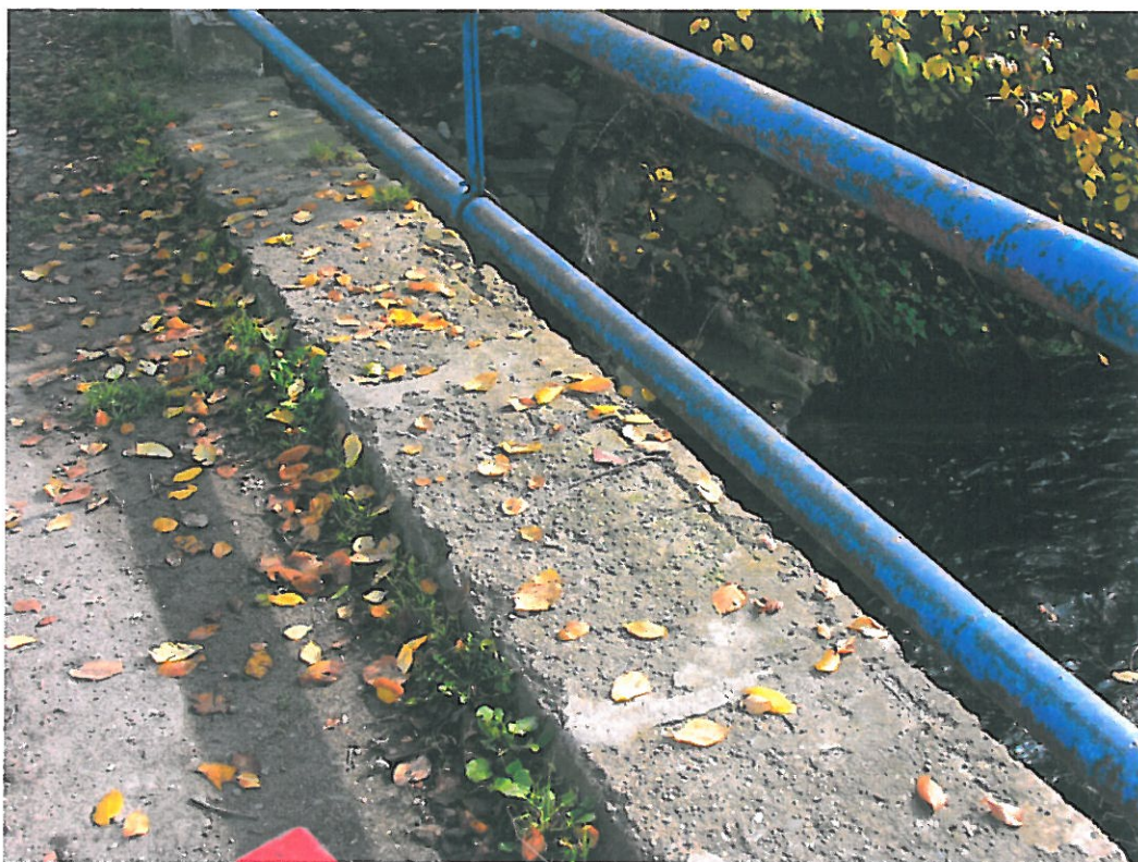
Fot. nr 10 – Ubytki betonu na gzymsach od strony dolnej wody, widoczne odsłonięte zbrojenie.
