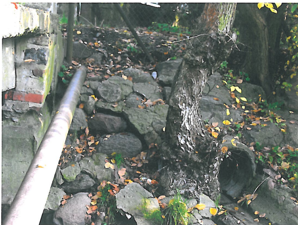
Fot. nr 22 – Uszkodzone umocnienie skarp.
