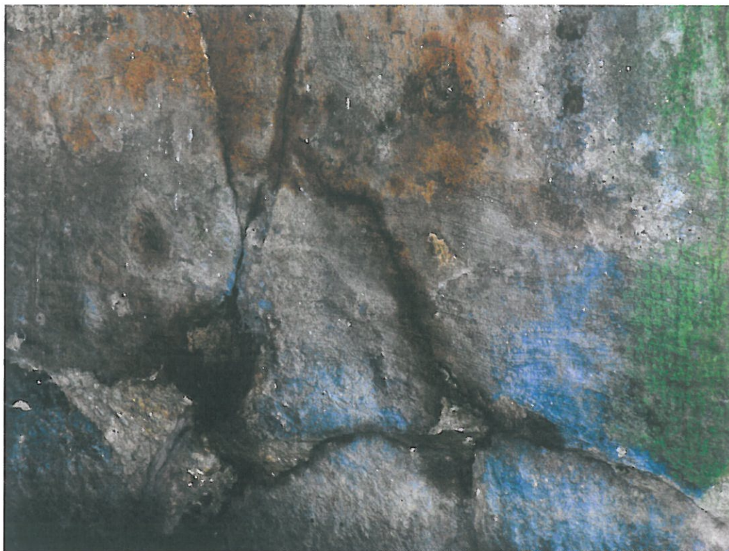
Fot. nr 21 – Pęknięcia korpusu przyczółka. Przebarwienia i wegetacja roślinna.
