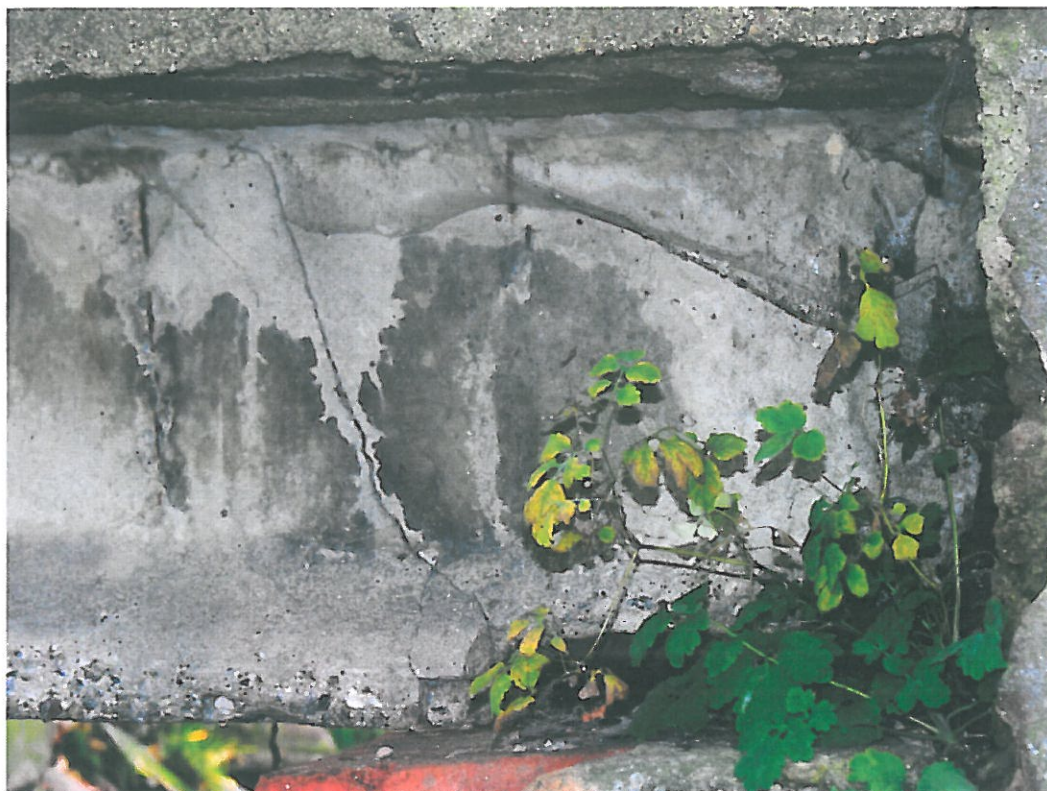
Fot. nr 13 – Ubytki betonu i odsłonięte zbrojenie w belce skrajnej. Pęknięcie ukośne w miejscu podparcia.
