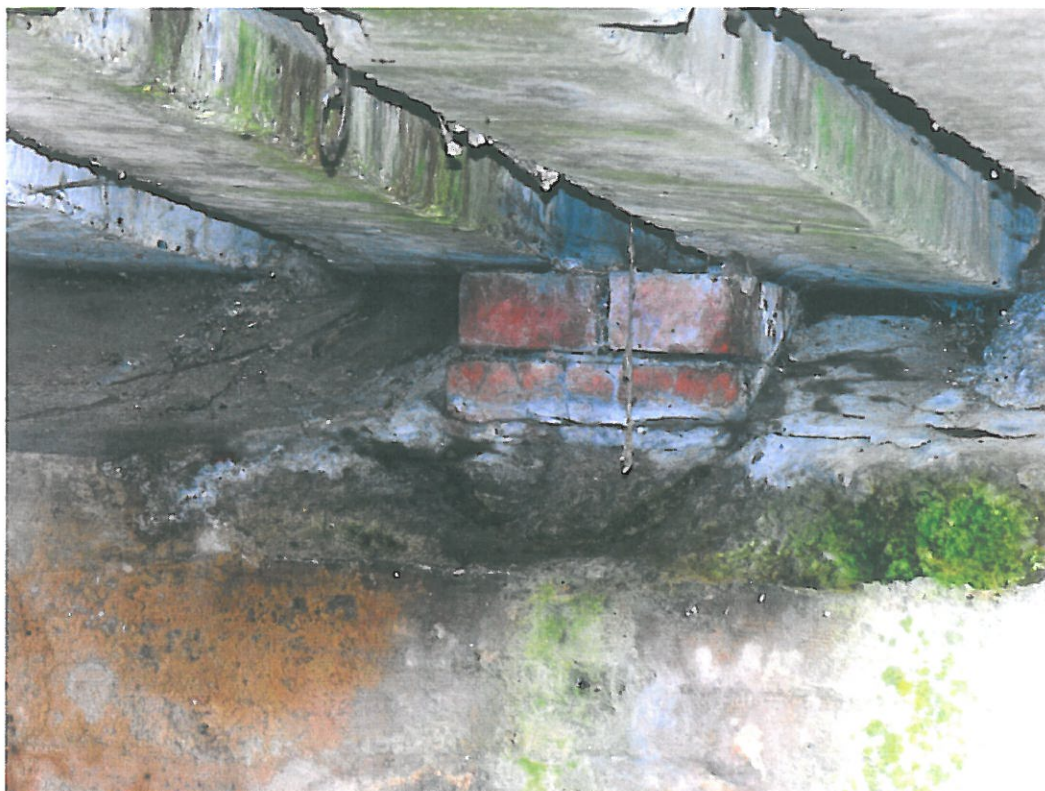
Fot. nr 17 – „Wypłukany” beton na korpusie przyczółka. Nacieki z węglanu wapnia. Na belkach rdzawe przebarwienia. Widoczna wegetacja roślinna.
