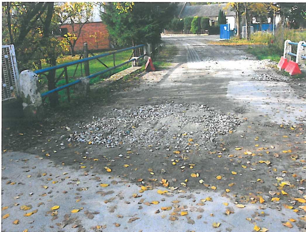
Fot. nr 9 – Brak nawierzchni na obiekcie. Ubytki uzupełnione kamieniem łamanym.
