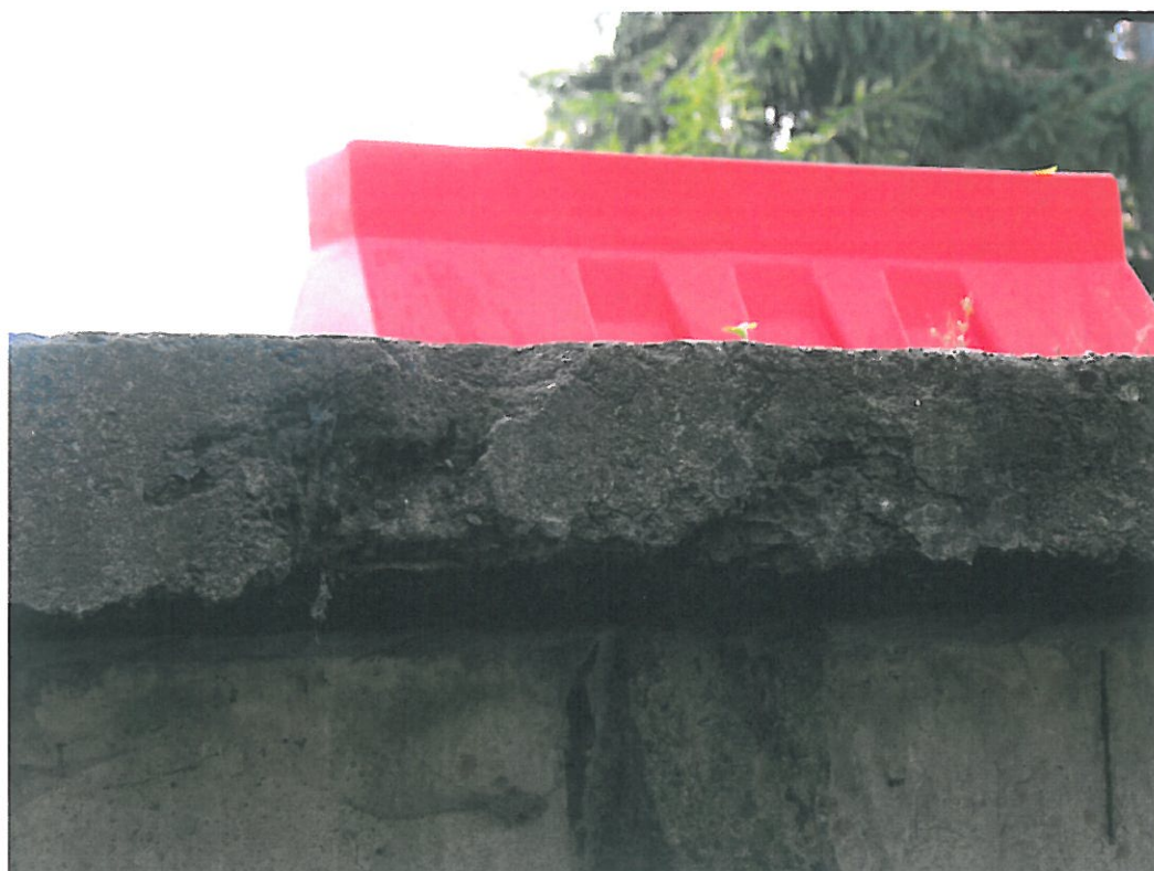
Fot. nr 12 – Ubytki betonu na gzymsie.
