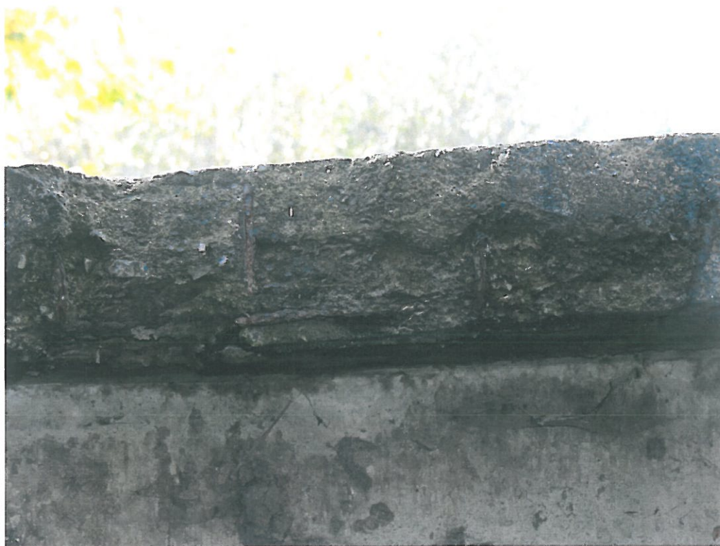
Fot. nr 11 – Ubytki betonu na gzymsie i korozja prętów zbrojeniowych.
