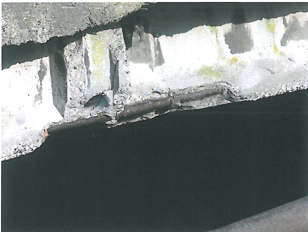
Fot. nr 14 – Ubytek betonu i odsłonięte zbrojenie w belce skrajnej.
