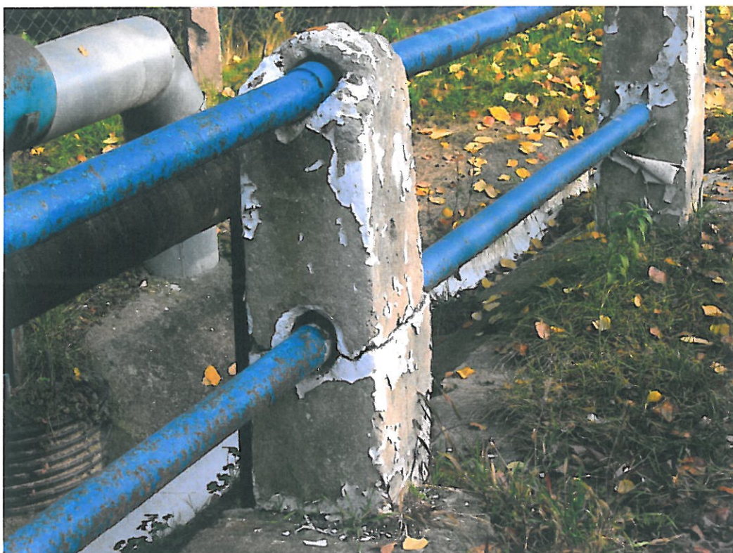
Fot. nr 8 – Ubytki betonu i pęknięcie poziome słupka balustrady od strony górnej wody.
