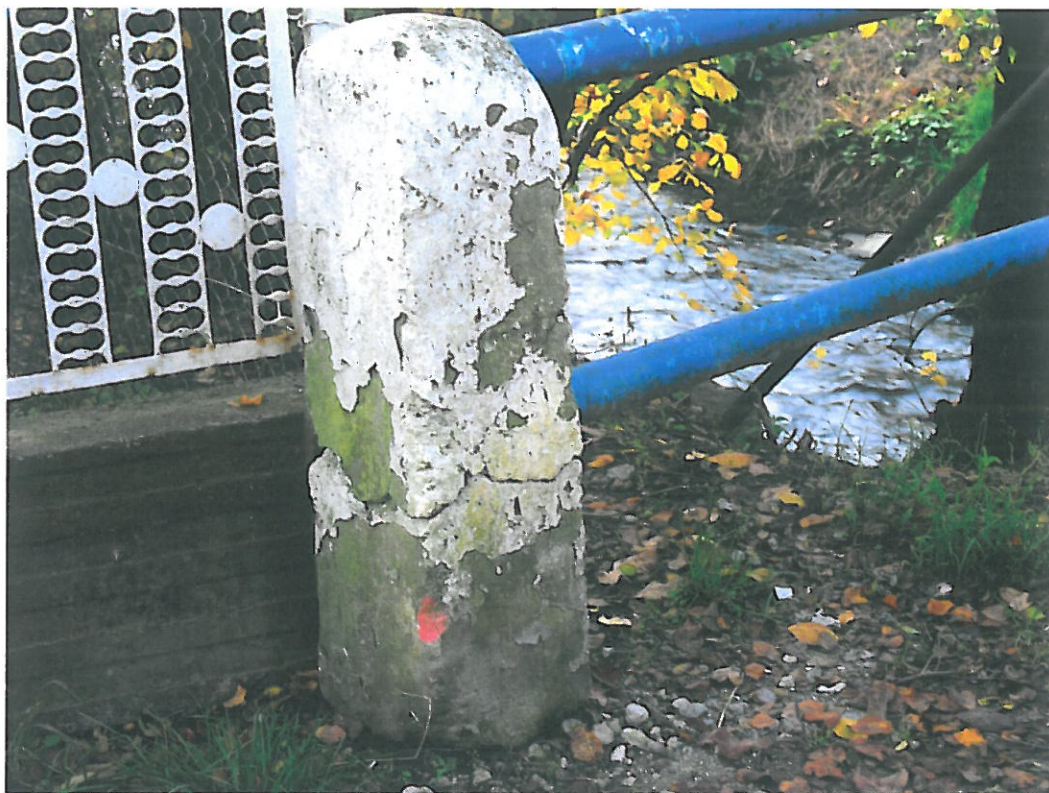
Fot. nr 5 – Ubytki betonu i pęknięcia na słupku balustrady od strony dolnej wody.
