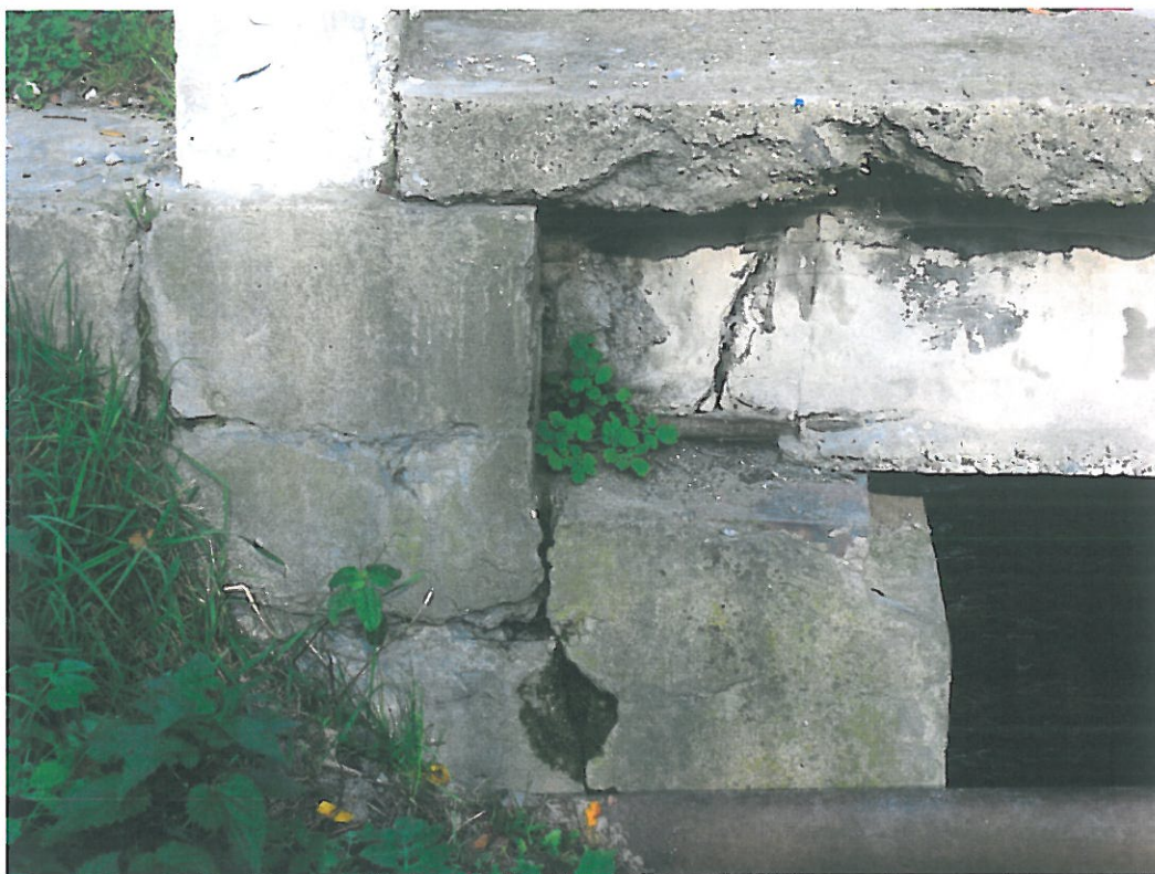
Fot. nr 15 – Ubytki betonu i odsłonięte zbrojenie w belce skrajnej. Pęknięcie ukośne w miejscu podparcia.
