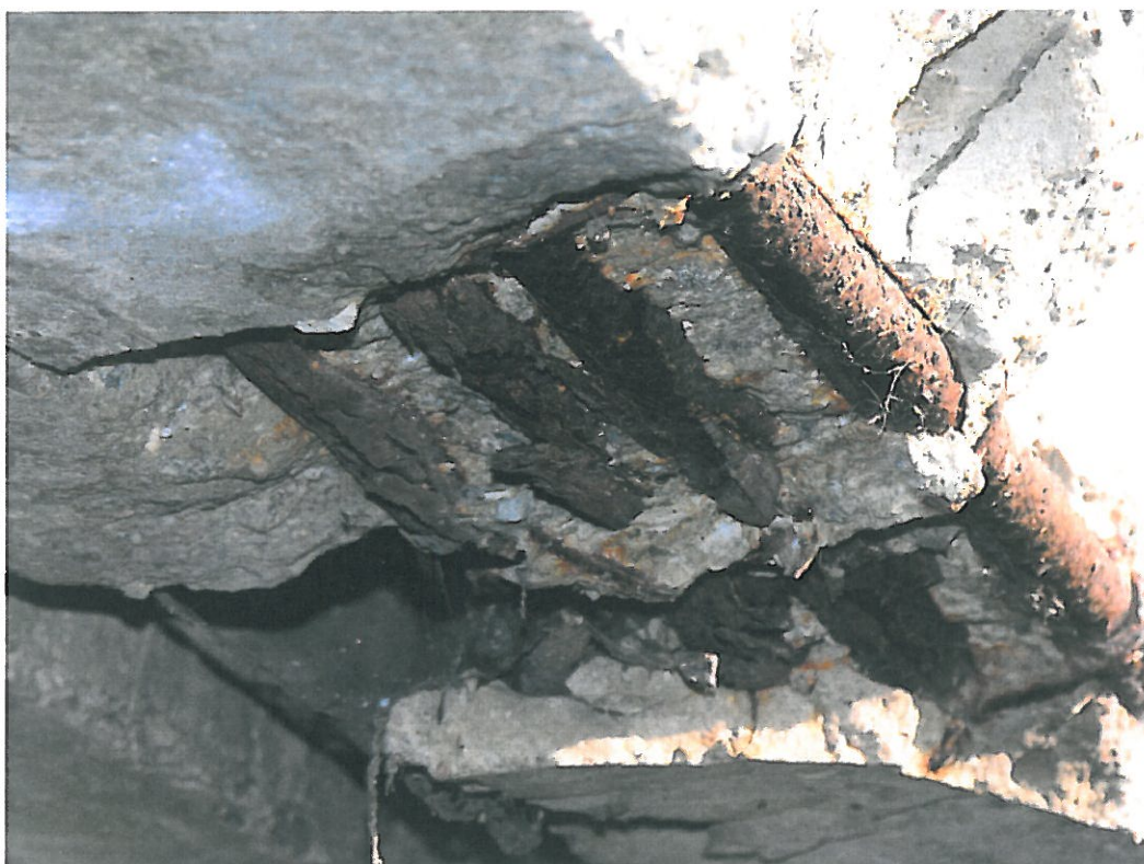
Fot. nr 16 – Ubytek betonu i odsłonięte, skorodowane zbrojenie na gzymsie.
