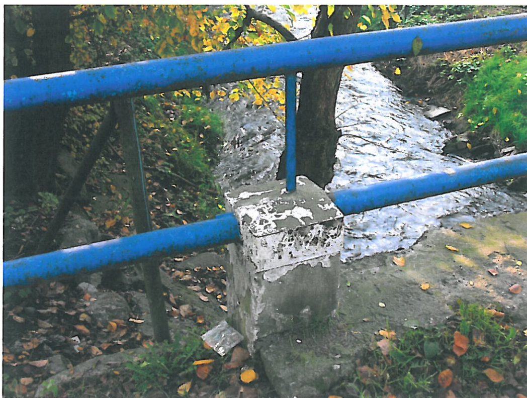
Fot. nr 6 – Korozja rur balustrady.
