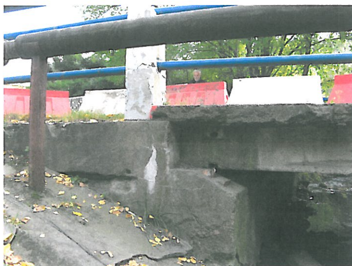
Fot. 2.8 ubytki betonu, pęknięcie – skrzydło przyczółka
