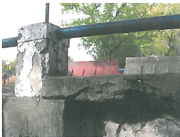
Fot. 2.10 uszkodzone, betonowe słupki balustrady
