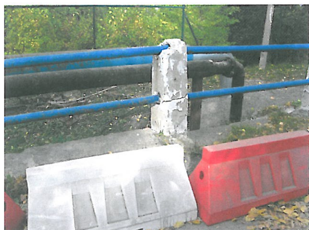
Fot. 2.9 uszkodzone, betonowe słupki balustrady
