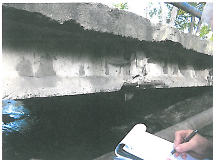
Fot. 2.5 odsłonięte zbrojenie
