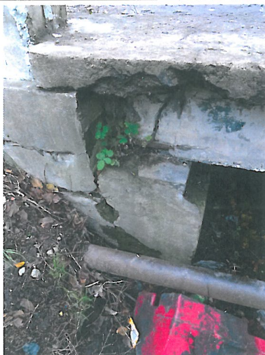
Fot. 14. Głębokie ubytki i korozja betonu gzymsów. Ubytki i korozja betonu przyczółka oraz zarysowania i pęknięcia z przeciekami wody. Zarysowanie, ubytki i odsłonięte skorodowane zbrojenie dźwigara.
