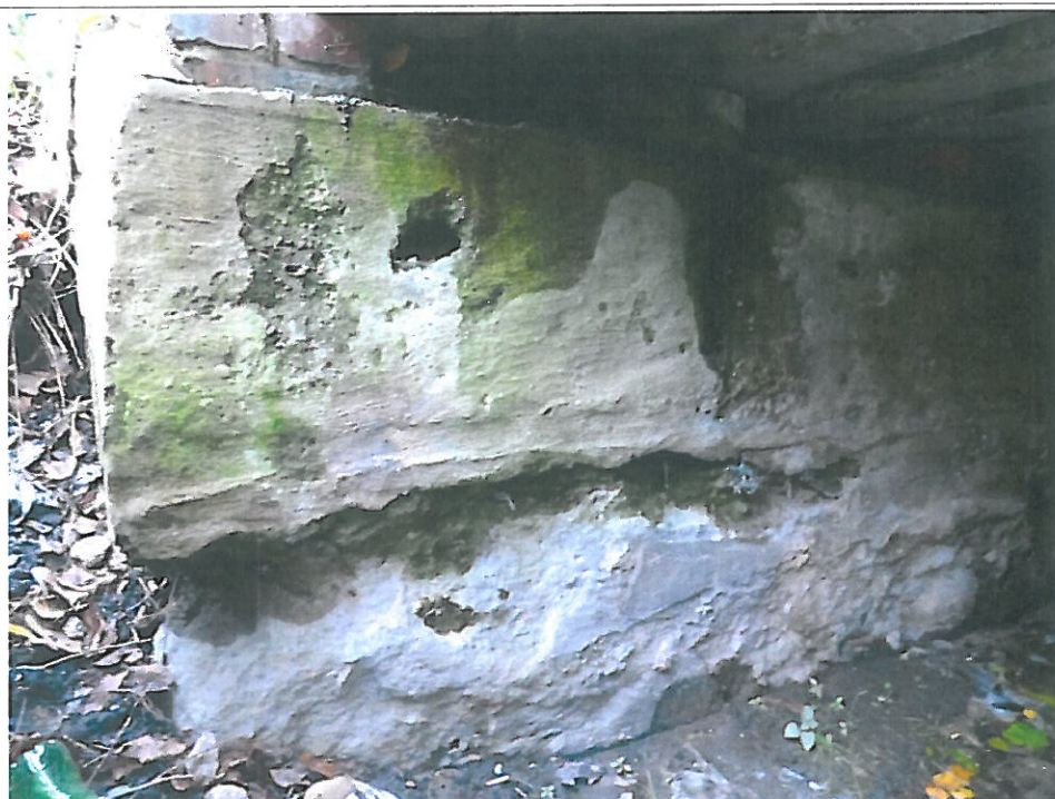
Fot. 16. Głębokie ubytki i korozja betonu przyczółka, zanieczyszczenia, zacieki z nieszczelnej dylatacji
