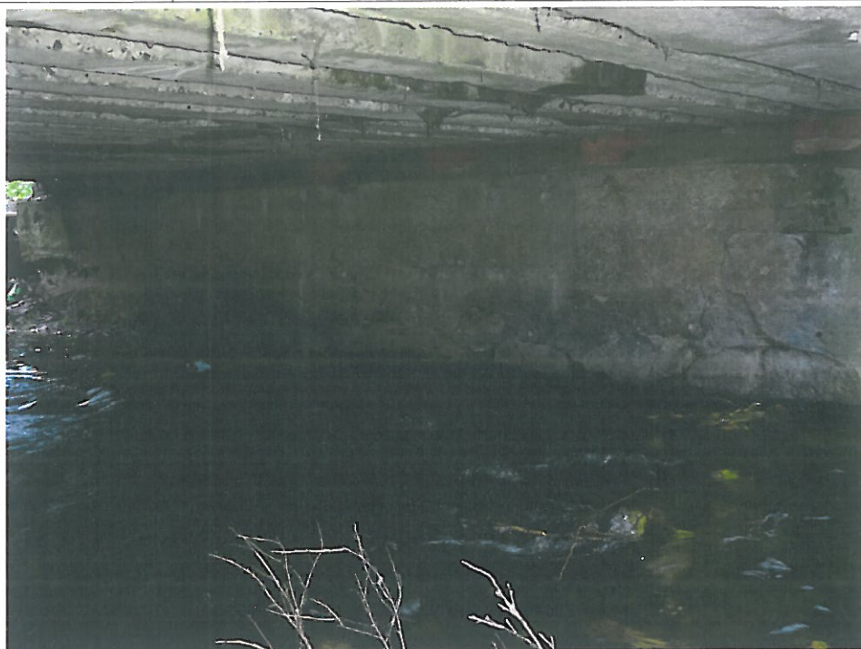
Fot. 15. Zawilgocone dźwigary konstrukcji nośnej świadczące o nieszczelnej izolacji. Ubytki i korozja betonu przyczółka
