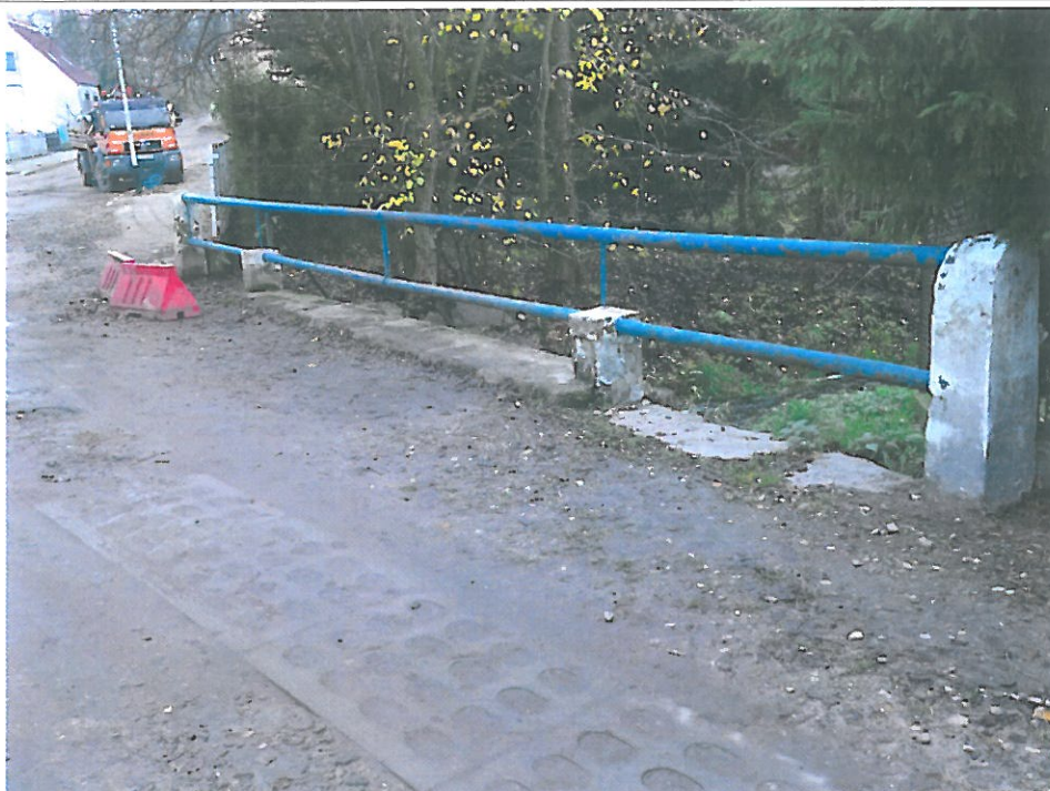
Fot. 9. Brak części barier ograniczających szerokość skrajni jezdni. Zanieczyszczenia i wegetacja roślinności na poboczu. Ubytki powłoki malarskiej balustrad
