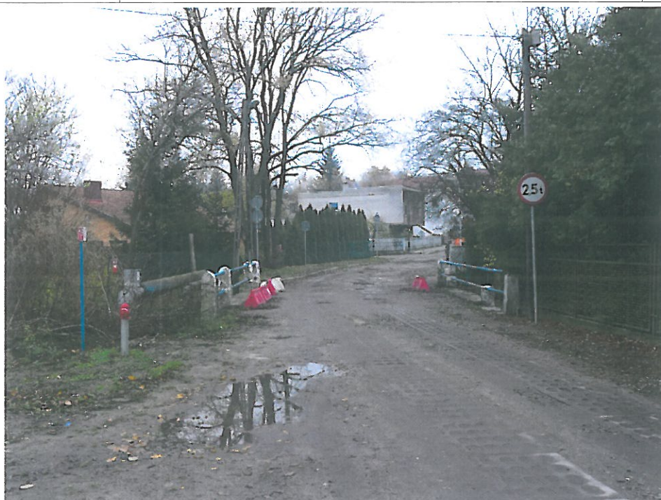
Fot. 3. Droga na obiekcie i dojazdach – widok w kierunku centrum
