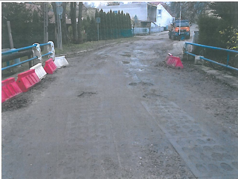
Fot. 7. Zanieczyszczenia i ubytki nawierzchni jezdni na moście i dojazdach. Ubytki barier ograniczających szerokość skrajni jezdni
