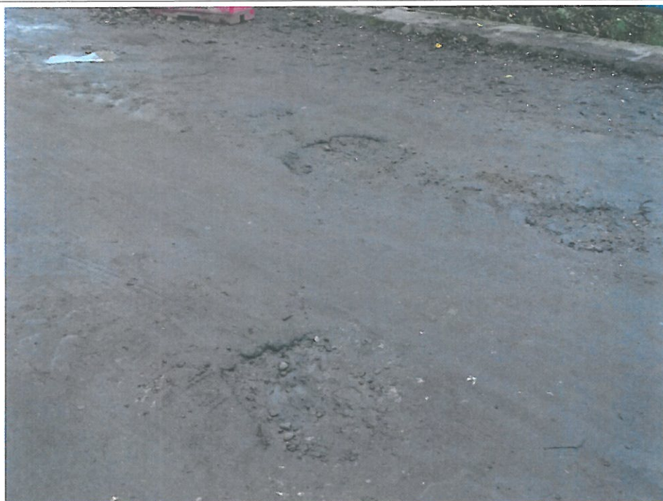
Fot. 8. Zanieczyszczenia i ubytki nawierzchni jezdni na moście
