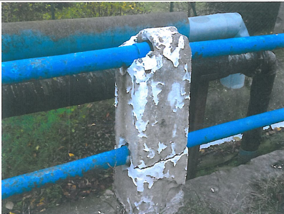
Fot. 10. Pęknięcie słupka balustrady oraz ubytki powłoki malarskiej
