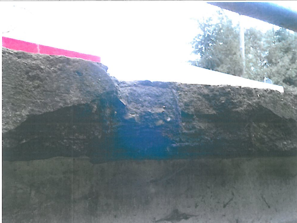
Fot. 13. Głębokie ubytki i korozja betonu gzymsów oraz odsłonięte, skorodowane zbrojenie.
