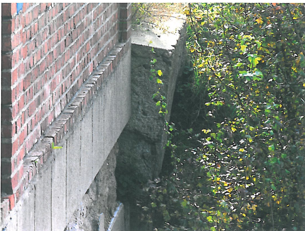
Fot. nr 10 – Przemieszczenia i ubytki betonu ściany oporowej.
