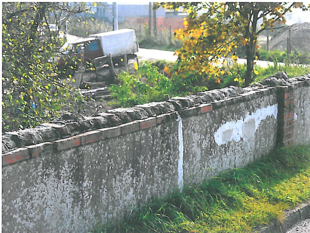
Fot. nr 13 – Ubytki betonu na poziomie wahań zwierciadła wody.
