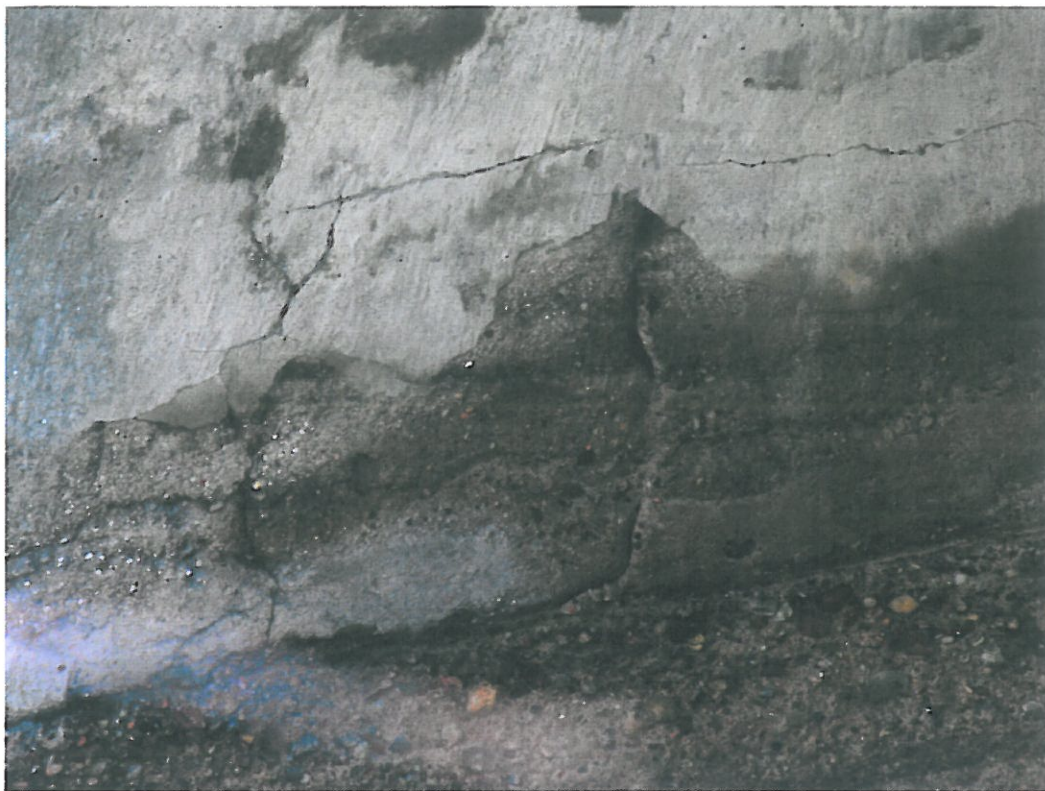
Fot. nr 5 – Ubytki betonu i poziome pęknięcia w okolicy podparcia łuku.
