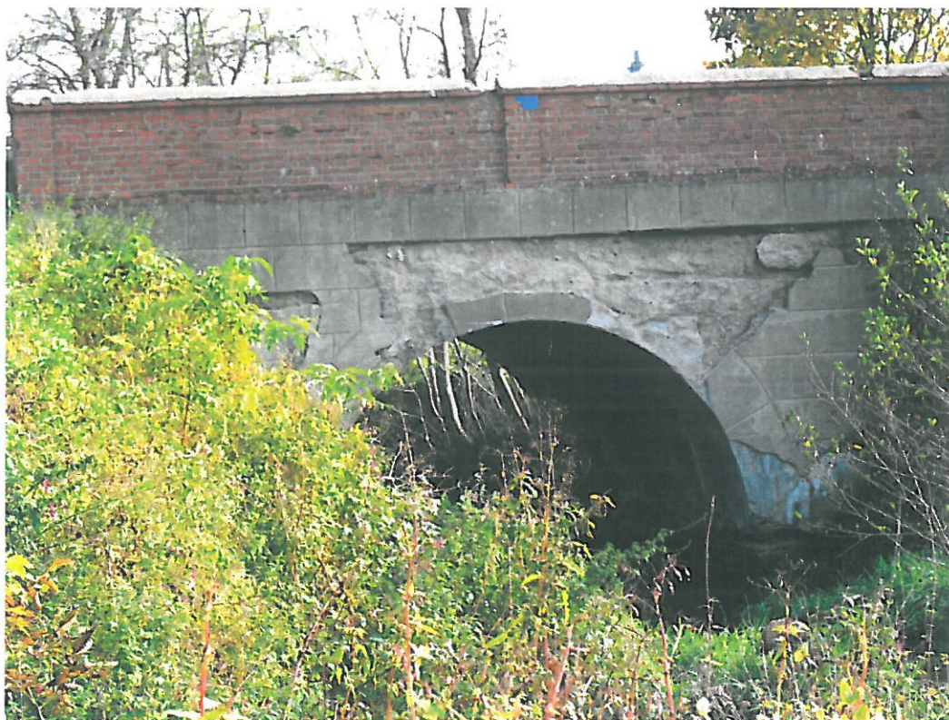
Fot. nr 9 – Ubytki tynku na ścianie czołowej i sklepieniu.
