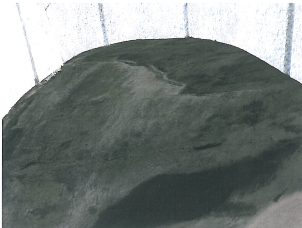
Fot. nr 6 – Poziome pęknięcia na sklepieniu łuku. Widoczne oznaki wegetacji roślinnej. Przebarwienia.
