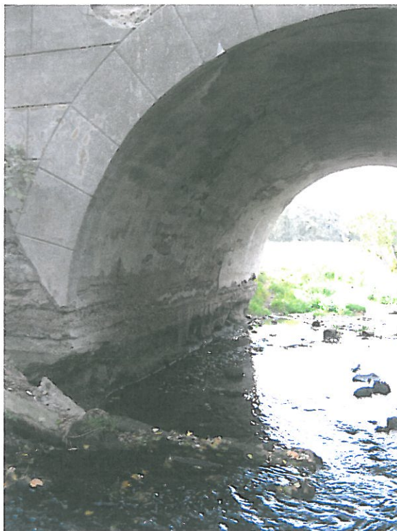
Fot. 2.9 korozja, ubytki betonu na podniebieniu łuku
