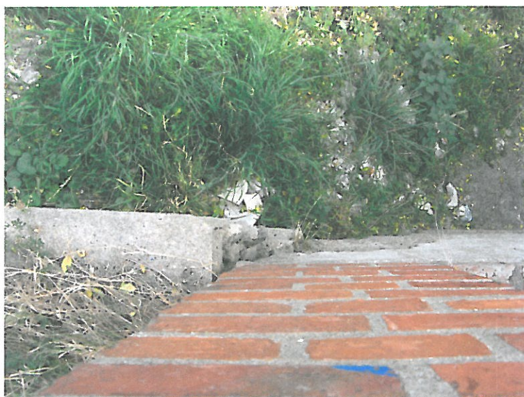
Fot. 2.8 przemieszczone skrzydło – od strony górnej wody
