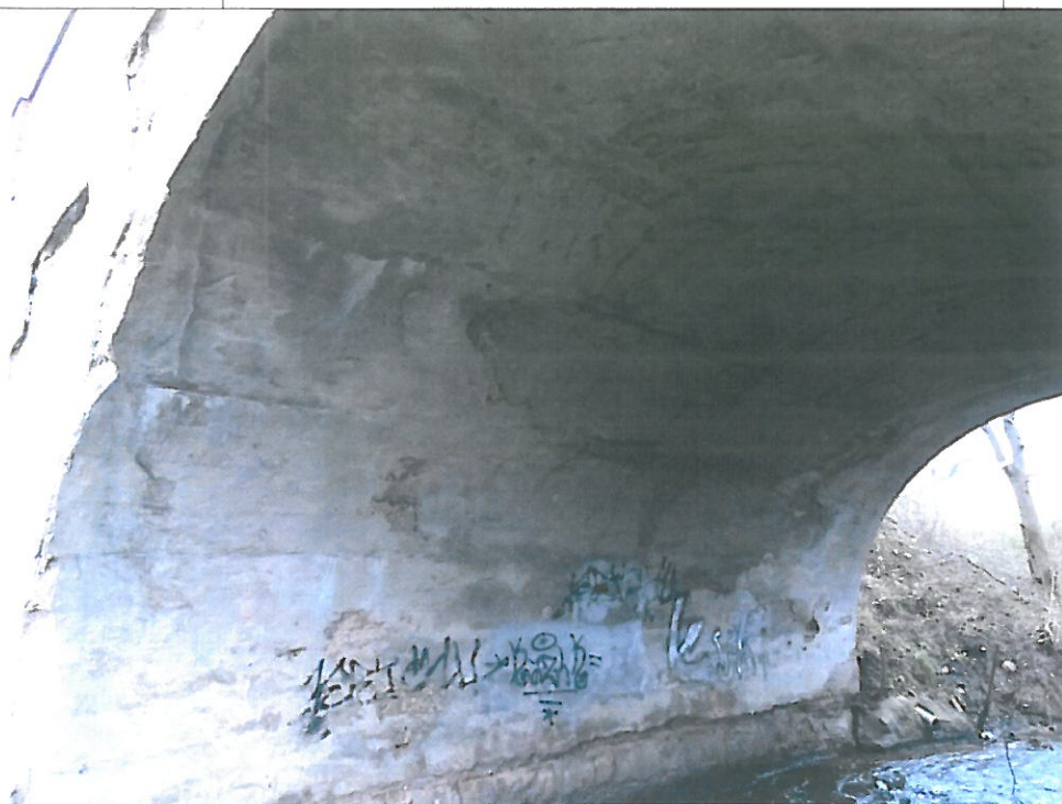
Fot. 17. Uszkodzenia sklepienia: zanieczyszczenie (graffiti), zarysowania, przecieki z białymi osadami oraz ubytki betonu
