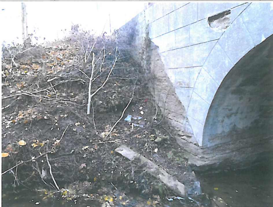
Fot. 11. Przemieszczenia i ubytki skarpy rzeki przy obiekcie oraz zanieczyszczenia
