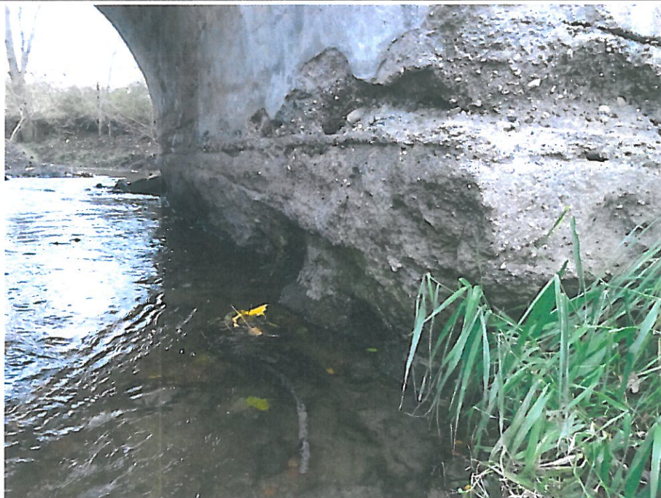
Fot. 16. Głębokie ubytki betonu fundamentów mostu
