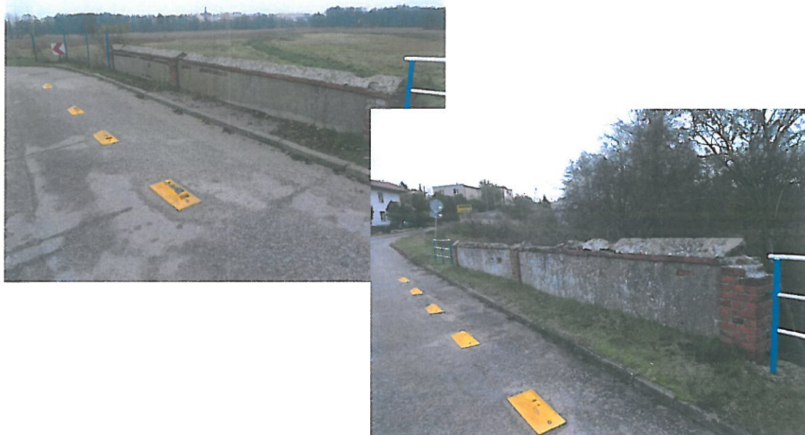
Fot. 7. Uszkodzenia barier murowanych
