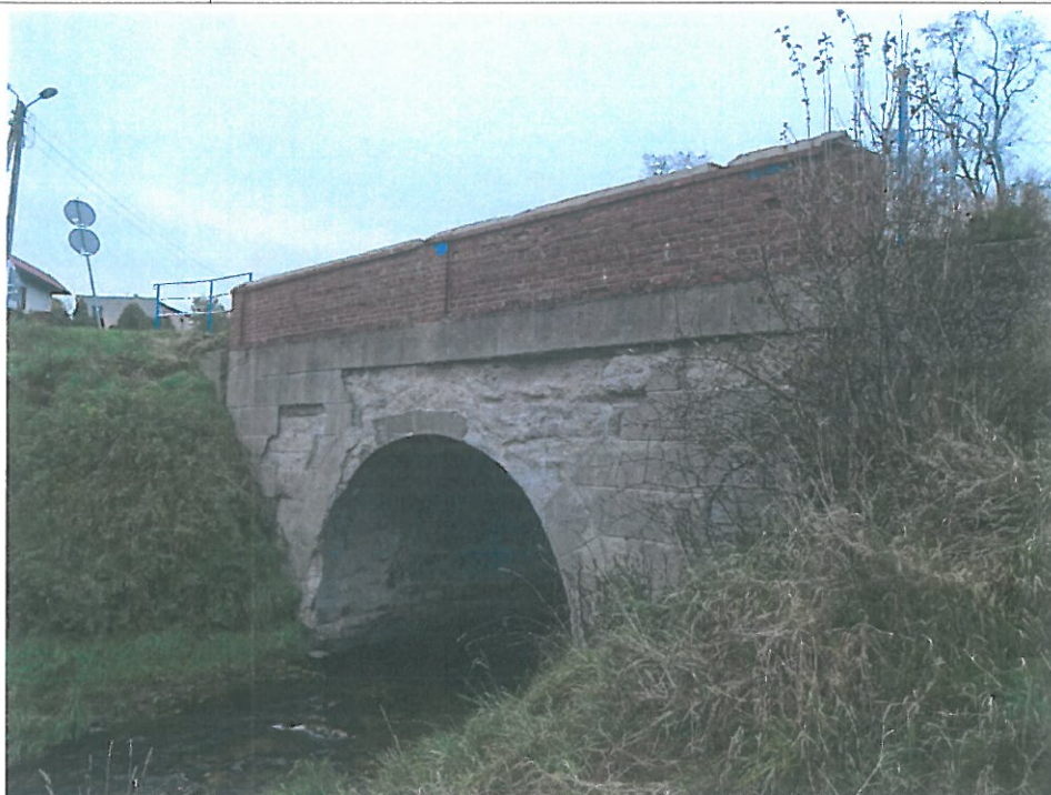
Fot. 13. Głębokie ubytki betonu ściany bocznej (zachodniej)
