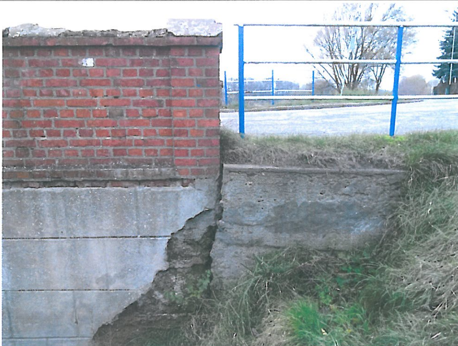
Fot. 12. Przemieszczenia i ubytki skarpy rzeki przy obiekcie; ubytki betonu ścianki skrzydełka i murka oporowego.
