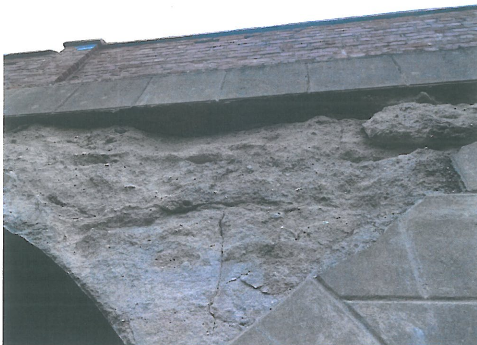
Fot. 15. Głębokie ubytki betonu ściany bocznej zachodniej, zarysowania i pęknięcia sklepienia
