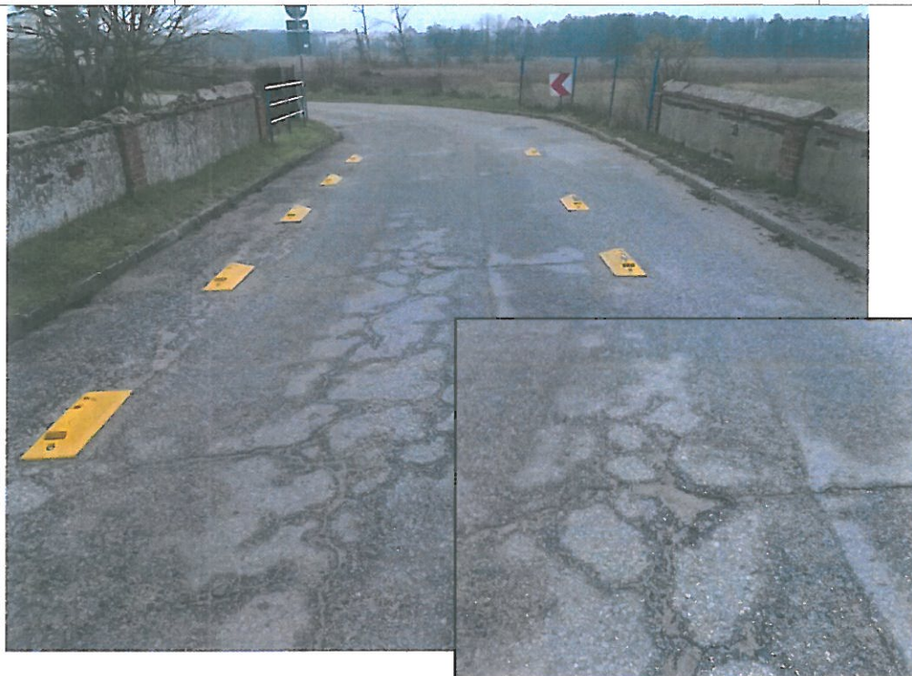
Fot. 9. Uszkodzenia nawierzchni jezdni na moście i dojazdach – zarysowania i pęknięcia
