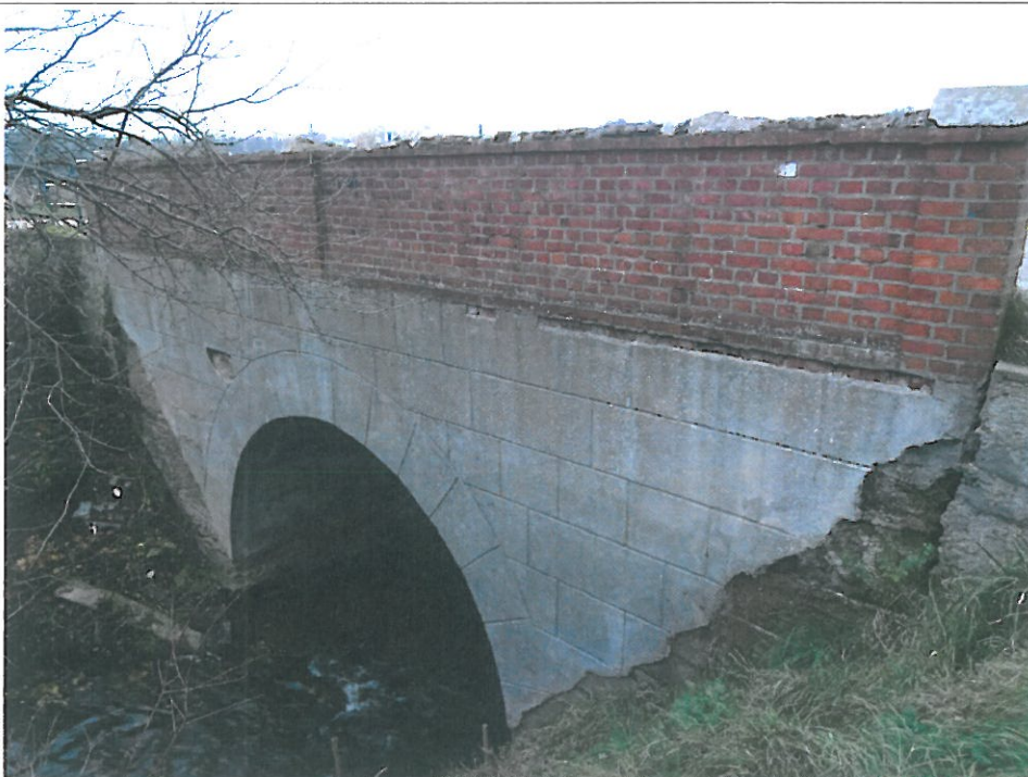
Fot. 14. Ubytki betonu ściany bocznej (wschodniej)
